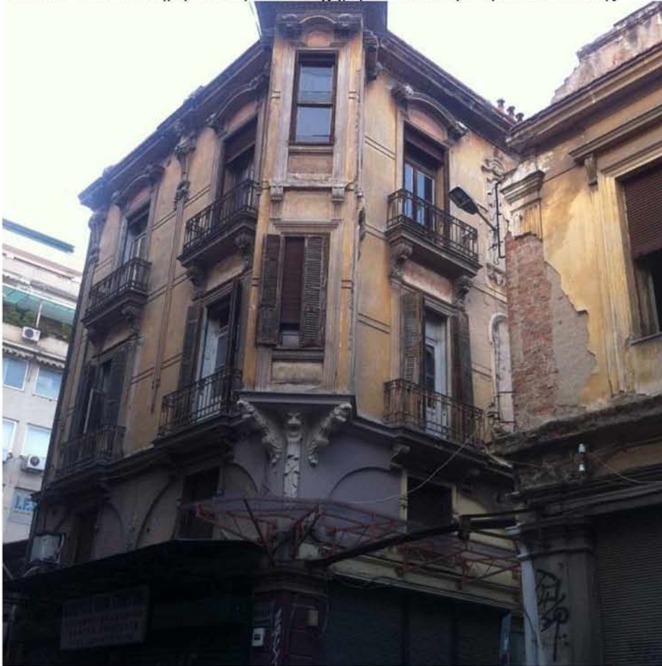
Εικόνα 4.15: Διατηρητέο κτίριο σε άσχημη κατάσταση στην οδό Εδέσσης
