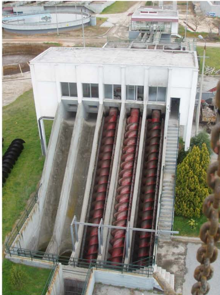
Εικόνα 4-5: Ανυψωτικοί κοχλίες τύπου Αρχιμήδη στην ΕΕΛ Λάρισας
