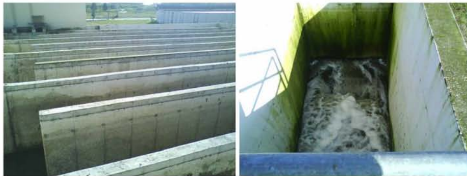
Εικόνα 4.14 – 4.15: Χλωρίωση και φρεάτιο εξόδου επεξεργασμένου νερού.
