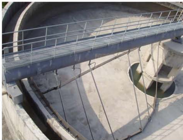
Εικόνα 4-9: Δεξαμενή πρωτοβάθμιας καθίζησης.
