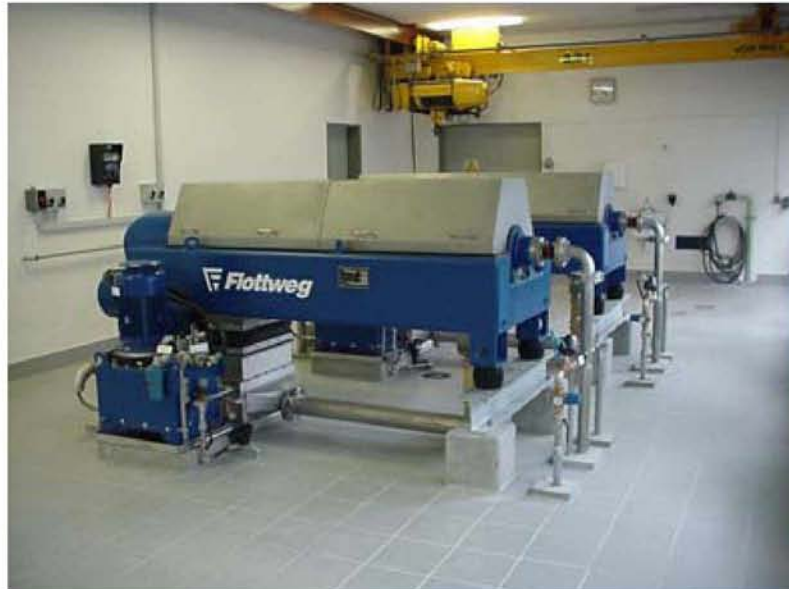
Εικόνα 4-18: Μονάδα μηχανικής πάχυνσης ιλύος.
