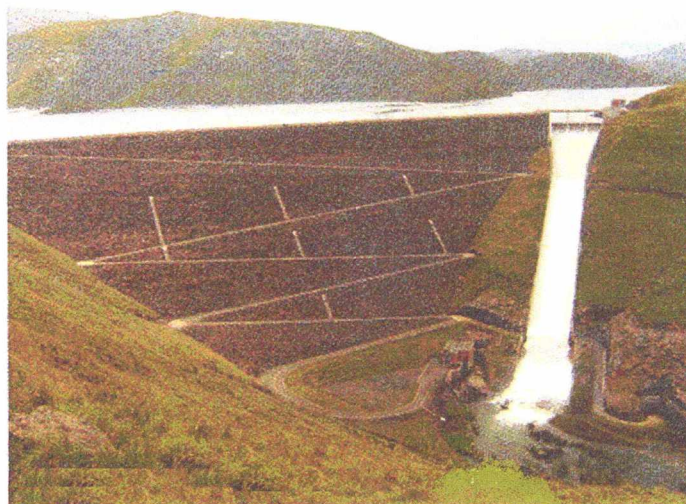
Σχήμα 28: Η υπερχείλιση του Mohale μετά τις πλημμύρες.
