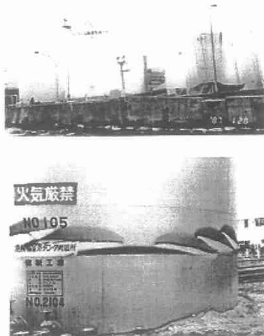
Εικόνα 1.2.10: Ζημιές σε δεξαμενές πετροχημικής βιομηχανίας, σεισμός στο Kobe της Ιαπωνίας, 1995
