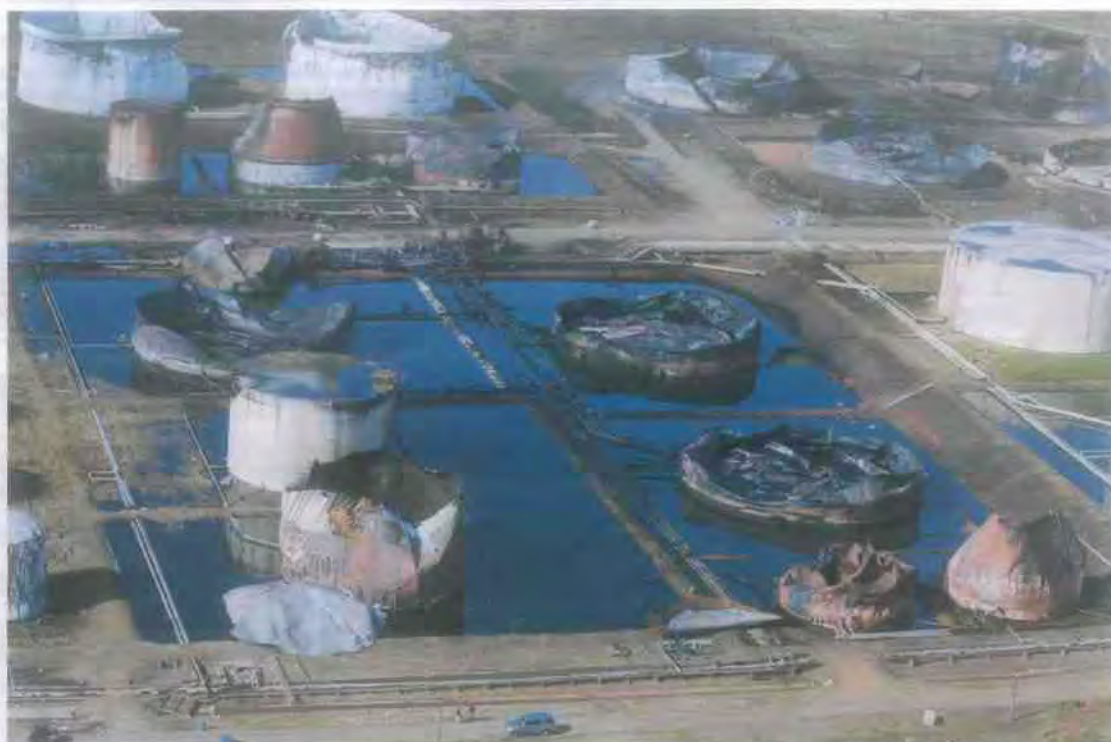
Εικόνα 1.2.4: Κατεστραμμένες δεξαμενές από πυρκαγιά, (PuertoRico refinery -FEMA photo library)
