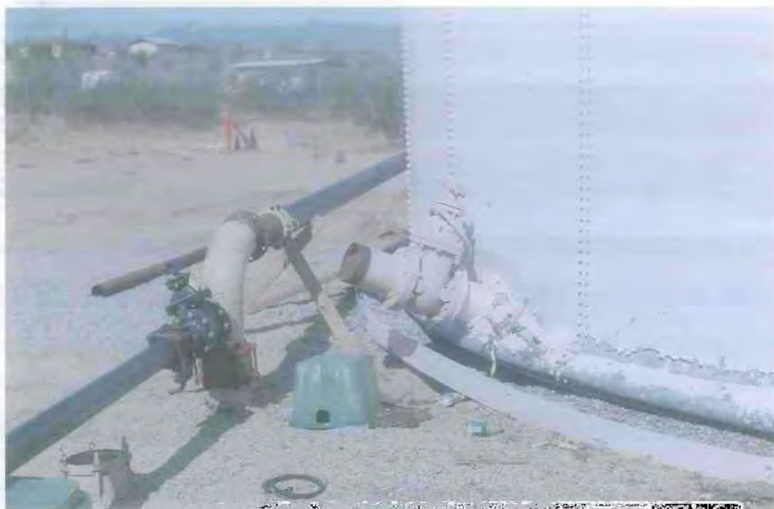
Εικόνα 1.2.8: Αστοχία σε σωληνώσεις δεξαμενής, APWA (American Public Works Association, photo archive)
