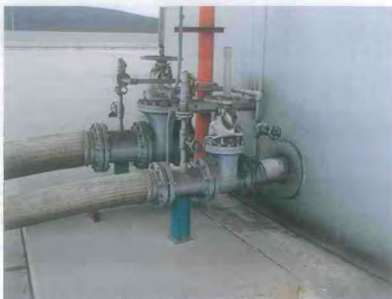
Εικόνα 1.2.9: Η τοποθέτηση ευκάμπτων σωληνώσεων αποτρέπει την αστοχία τους κατά την κίνηση της δεξαμενής από το σεισμό, 2001 Peru Earthquake (Photo courtesy of BFP Engineers).
