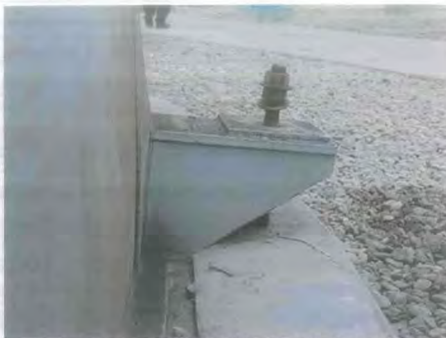
Εικόνα 1.2.2: Αστοχία στην αγκύρωση της δεξαμενής, 2001 Peru Earthquake. (Photo courtesy of BFP Engineers).
