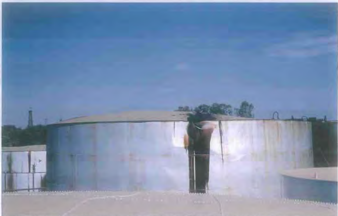
Εικόνα 1.2.7: Παραμορφωμένο τοίχωμα δεξαμενής και οροφής λόγω κυματισμού του ρευστού με αποτέλεσμα τη διαρροή αυτού ( "StrongMotions.Inc" photo archive).
