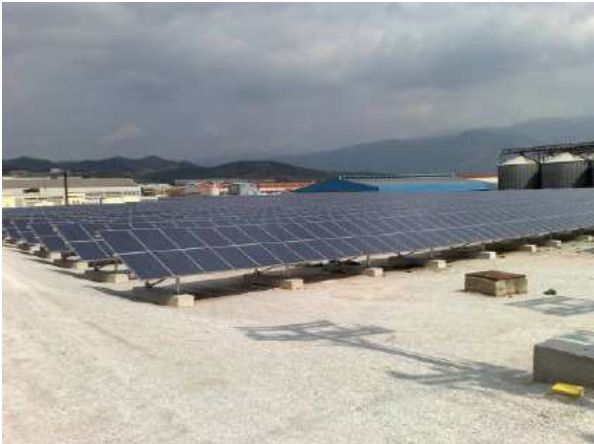
Εικόνα 6. Εγκατεστημένο σύστημα Φ/Β μεγέθους 2 MWp στη βιομηχανική Περιοχή του Βόλου.
