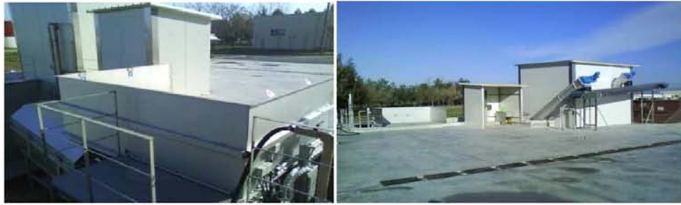
Εικόνα 4.5 – 4.6: Μονάδα επεξεργασίας λυμάτων αποφρακτικών στην ΕΕΛ Λάρισας.
