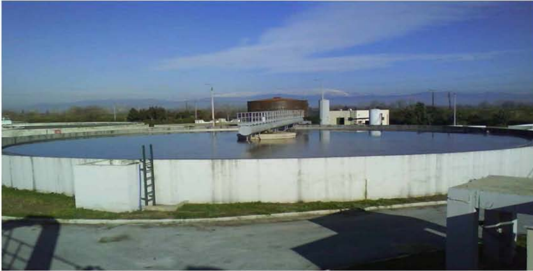
Εικόνα 4.21: Δεξαμενή Δευτεροβάθμιας καθίζησης.
