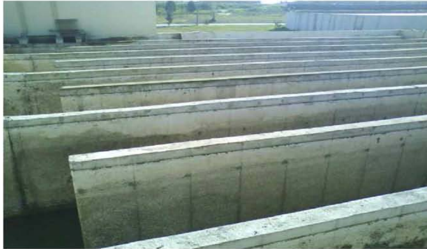
Εικόνα 4.22: Χλωρίωση επεξεργασμένου νερού
