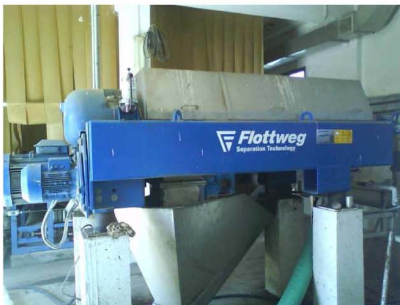
Εικόνα 4.35: Μονάδα μηχανικής αφυδάτωσης στην ΕΕΛ Λάρισας.
