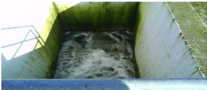
Εικόνα 4.23: Φρεάτιο εξόδου επεξεργασμένου νερού.
