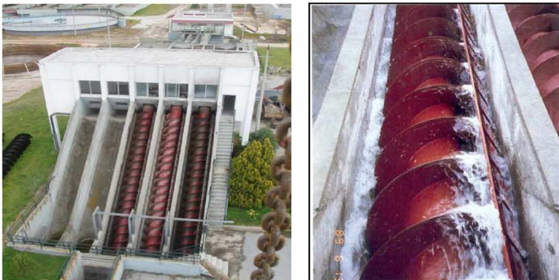
Εικόνα 4.7 - 4.8: Ανυψωτικοί κοχλίες τύπου Αρχιμήδη στην ΕΕΛ Λάρισας.
