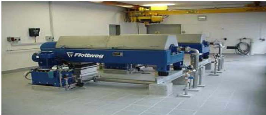
Εικόνα 4.26: Μονάδα μηχανικής πάχυνσης ιλύος.
