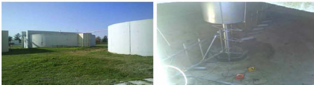
Εικόνα 4.24 – 4.25: Εξωτερικό και εσωτερικό παχυντή ιλύος.
