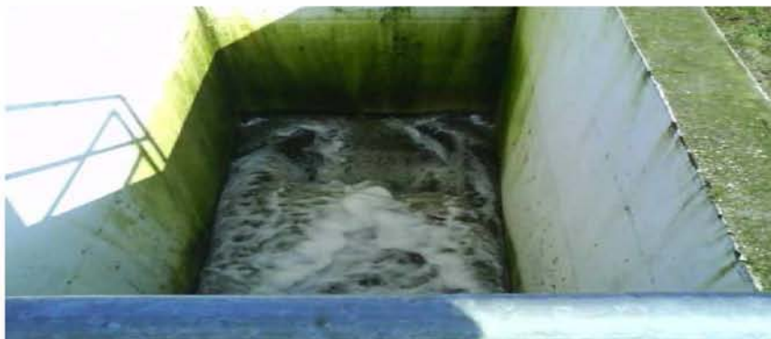
Εικόνα 4.23: Φρεάτιο εξόδου επεξεργασμένου νερού.
