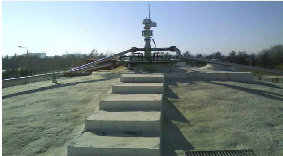
Εικόνα 4.30: Ασφαλιστικές δικλίδες υπερπίεσης οροφής χωνευτή.
