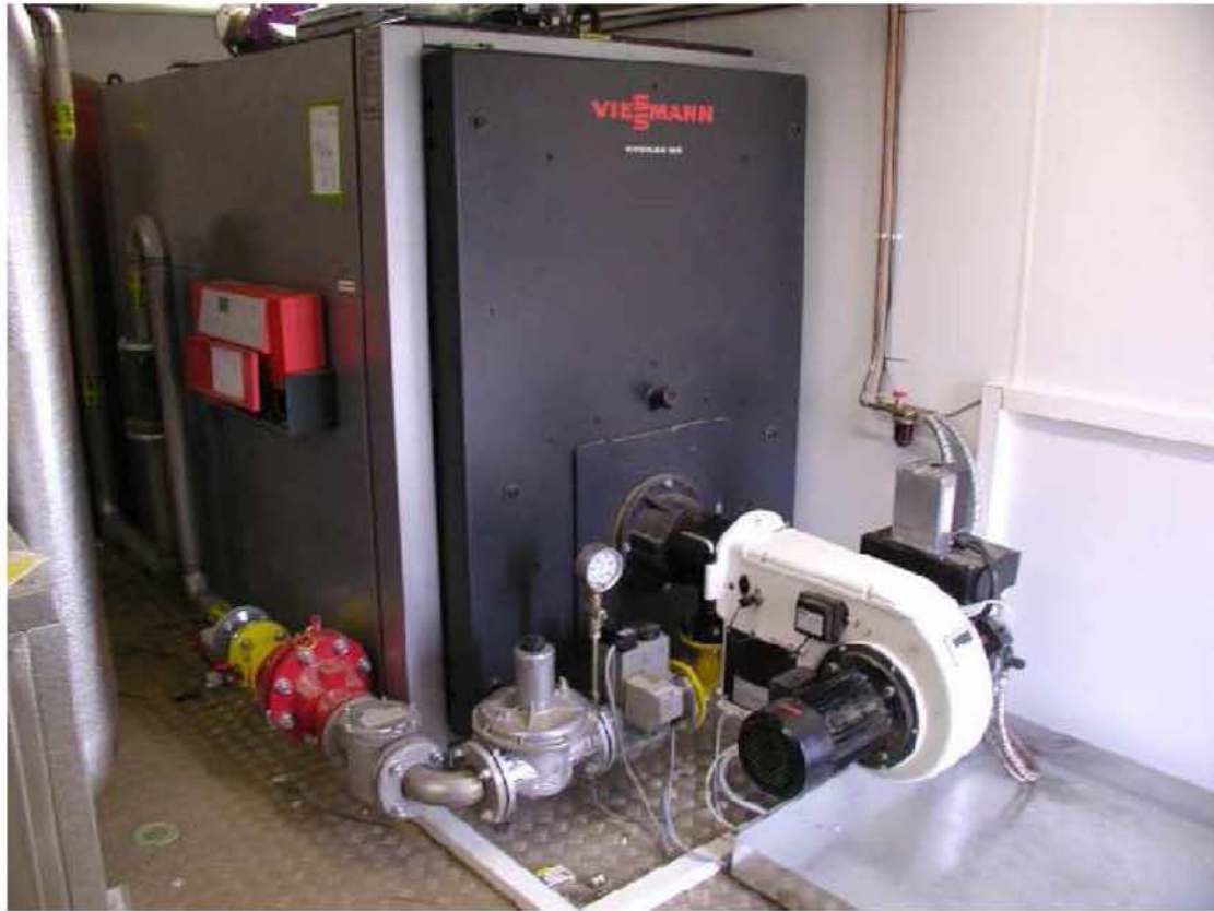
Εικόνα 3.1: Καυστήρας βιοαερίου για παραγωγή θερμότητας (AGRINZ GmbH, 2008)
