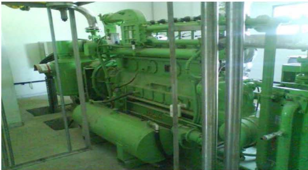
Εικόνα 4.31: Μηχανή παραγωγής ηλεκτρικής ενέργειας με βιοαέριο.
