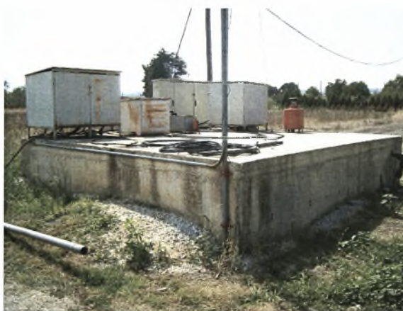
Εικόνα 5.7.γ. Τσιμεντένια δεξαμενή
