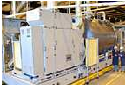
Σχήμα 1. 9: 300-kW SOFC/GT στην California στο Pittsburgh [8]
