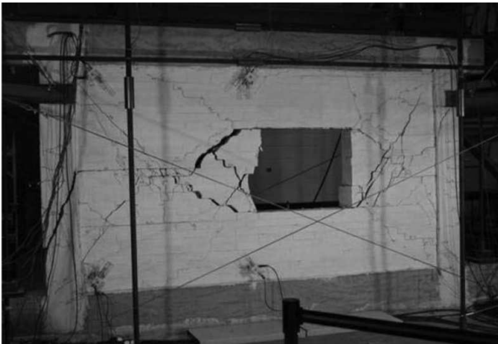
Σχ.3.54: Ρωγμές δοκιμίου SW μετά το πέρας του πειράματος.
