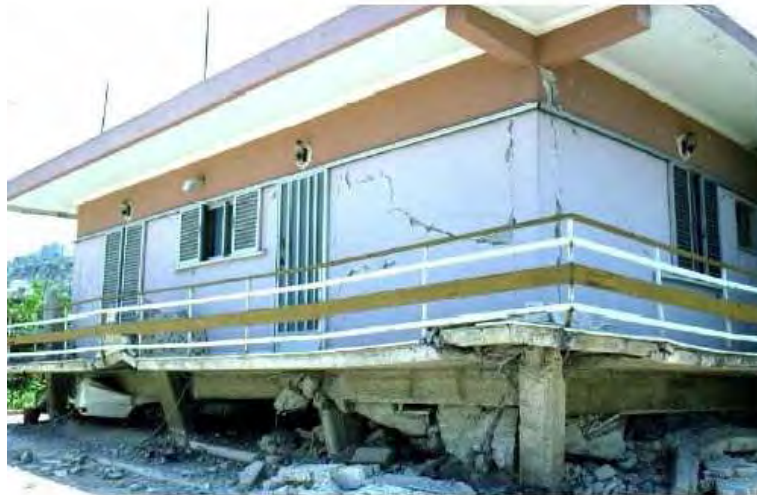
Φωτ. 1.1: Κατάρρευση κτίσματος λόγω αστοχίας μαλακού ορόφου (Φαινόμενο pilotis).
