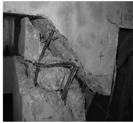
(β) διαμητική αστοχία υποστύλωματος
