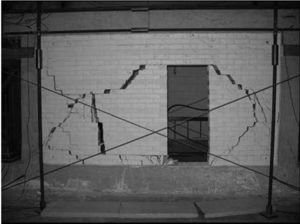
Σχ.3.57: Ρωγμές δοκιμίου D μετά το πέρας του πειράματος.
