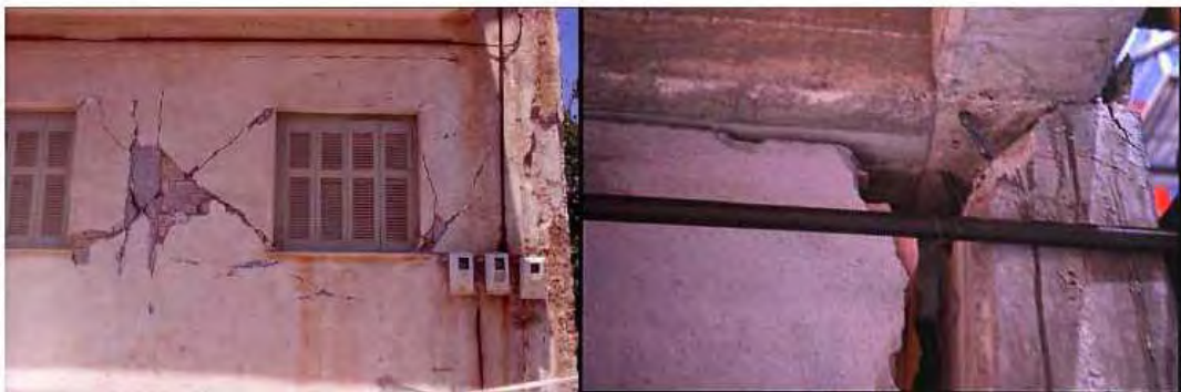
Φωτ. 1.4: Αστοχία υποστυλωμάτων λόγω ισχυρών τοιχοπληρώσεων.
