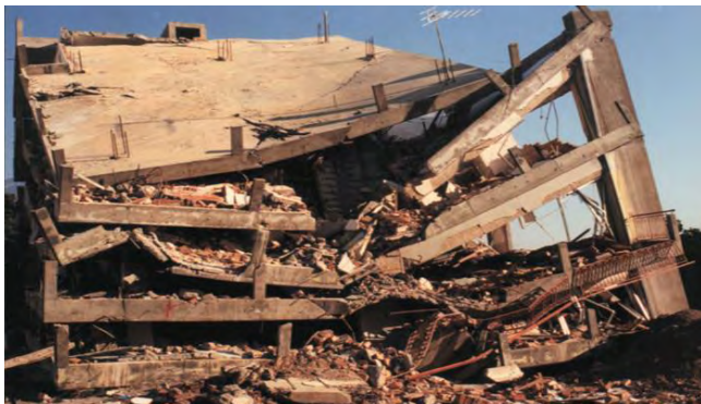
Εικόνες 32, 33, 34, 35, 36, 37. Εικόνες καταστροφής πόλης μετά το σεισμό (Πηγές: Εικόνες 32, 33, 34, 36, Διαμαντόπουλος, 1991, Εικόνα 35, Μπένος, 1999 και Εικόνα 37, http://www.elekkas.gr ).
