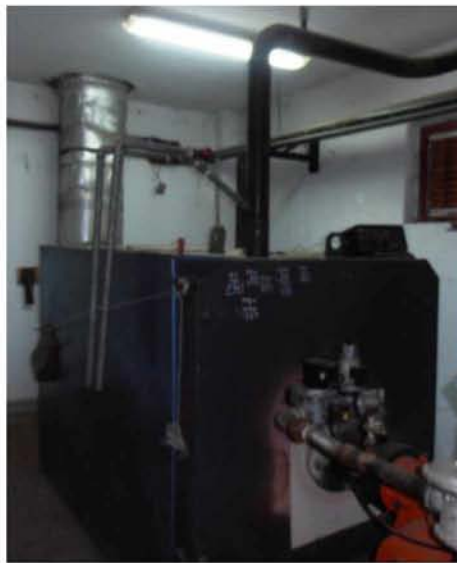
Εικόνα 2.12 Λέβητας κλειστού κολυμβητηρίου ισχύος 988 Kw.
