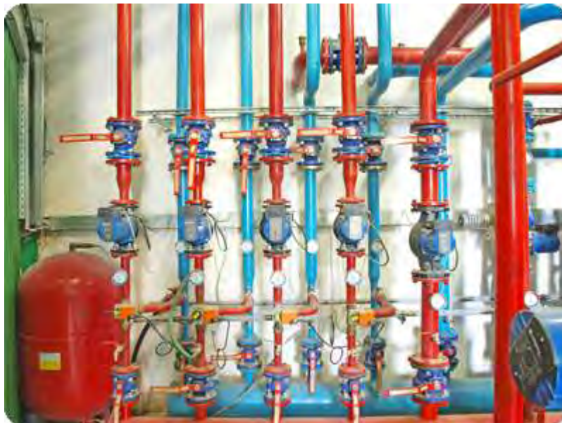
Εικόνα 46: Σύστημα θέρμανσης. (Πηγή:
