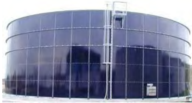
Εικόνα 41: Χωνευτήρας (βιοαντιδραστήρας). (Πηγή:
