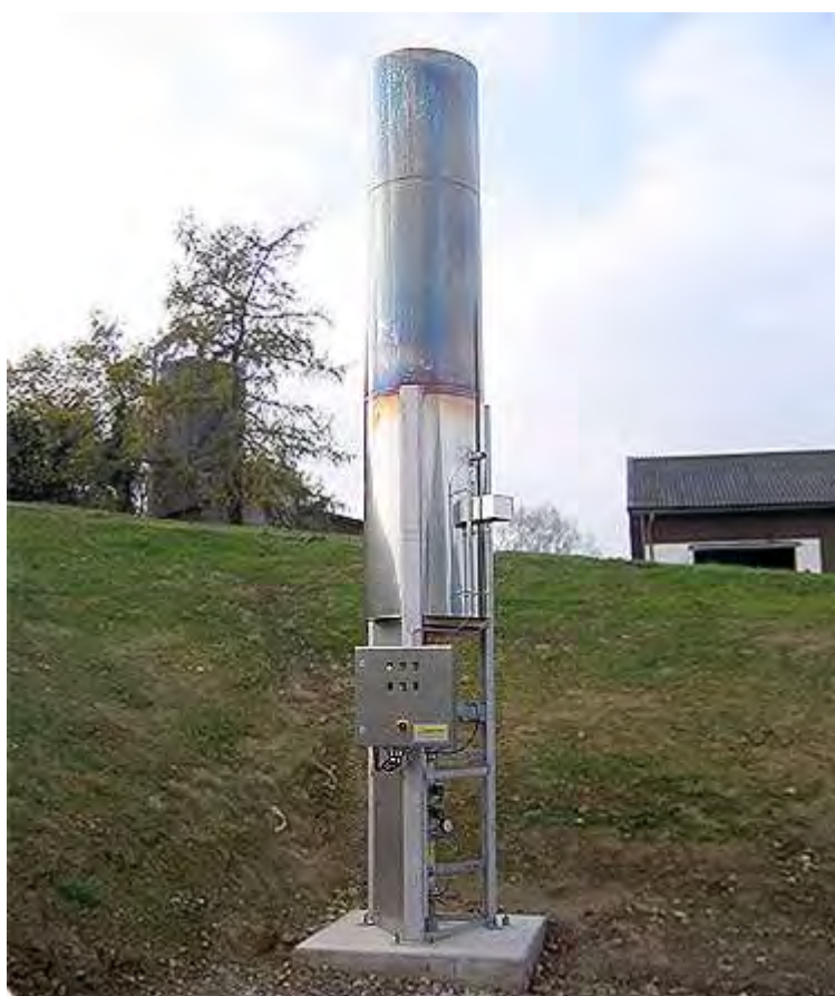
Εικόνα 48: Πυρσός καύσης περίσσειας βιοαερίου. (Πηγή:
