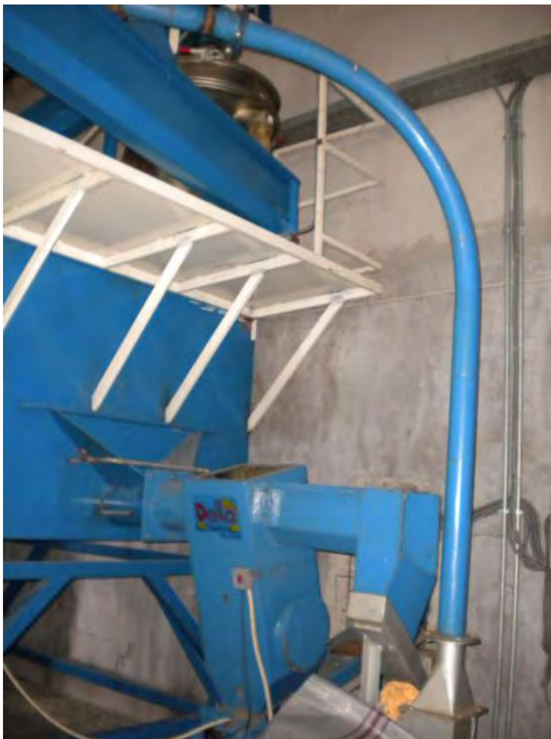
Εικόνα 24: Σπαστήρας (κάτω). Φυγοκεντρικό ανοξείδωτο και κοχλιομεταφορέας (πάνω). Δεξαμενή ψύξης (αριστερά).
