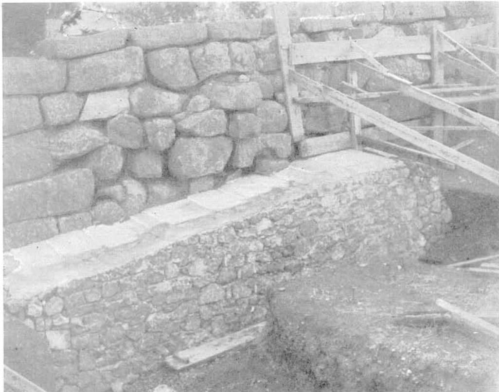
Δελφοί: α - β. Έργασιαι συντηρήσεως κατὰ τὴν ΝΑ. γωνίαν τοῦ περιβόλου τοῦ Ἱεροῦ
