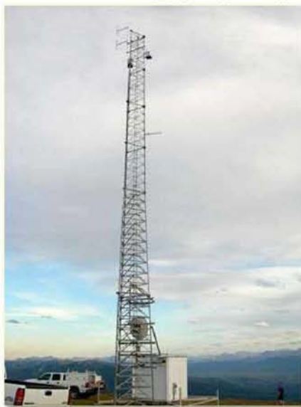
Εικόνα 6.10: Πύργος ανίχνευσης καπνού
