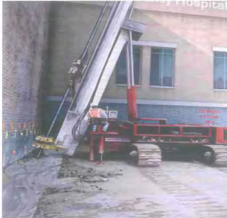
Σχήμα1.13 Φωτογραφία από εκτέλεση τσιμεντενέσεων για την βελτίωση των γεωτεχνικών συνθηκών θεμελίωσης υφιστάμενης κατασκευής
