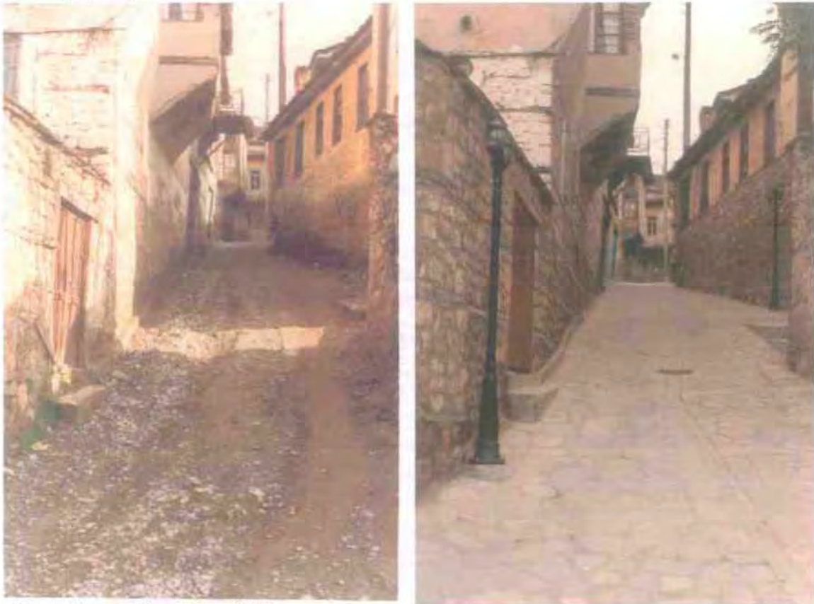
εικ.5.5: Η οδός Σοφού πριν και μετά την επέμβαση. Διακρίνεται καθαρά η καταστροφή του οδοστρώματος
