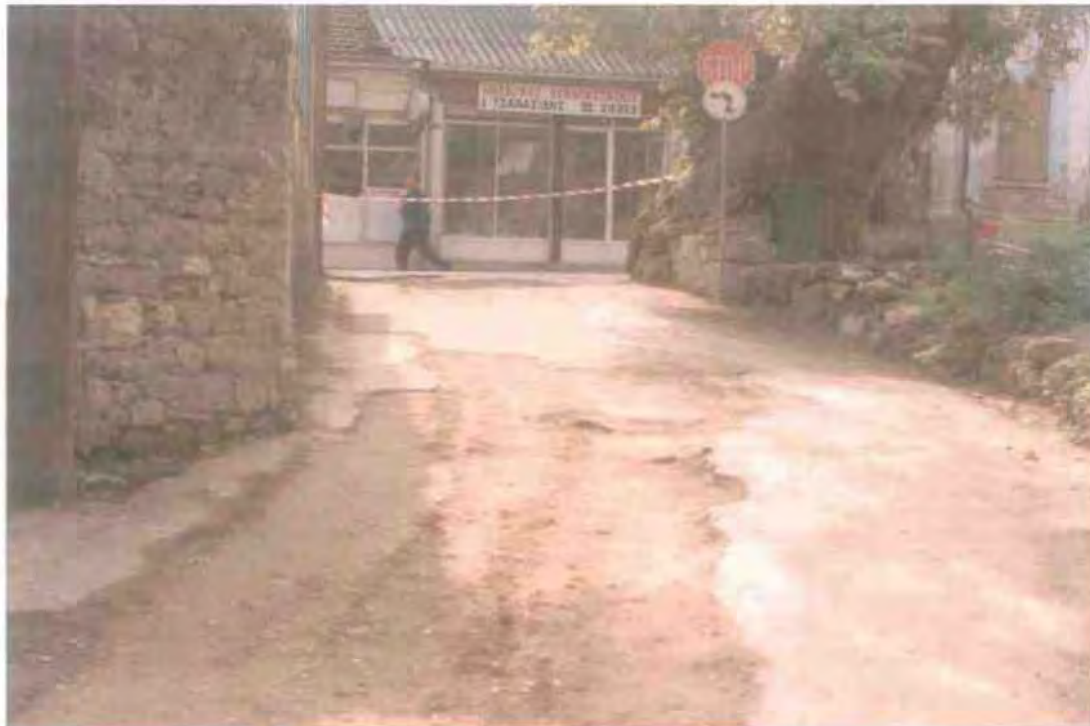
εικ.5.6: Η οδός Γουδή πριν και μετά την επέμβαση. Διακρίνεται καθαρά η καταστροφή του οδοστρώματος
