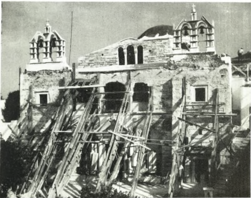
β. Ἡ πρόσοψις τοῦ ναοῦ τῆς Καταπολιανῆς κατὰ τὴν διάρκειαν τῶν ἐργασιῶν ἀναπαλαιώσεως αὐτῆς.
