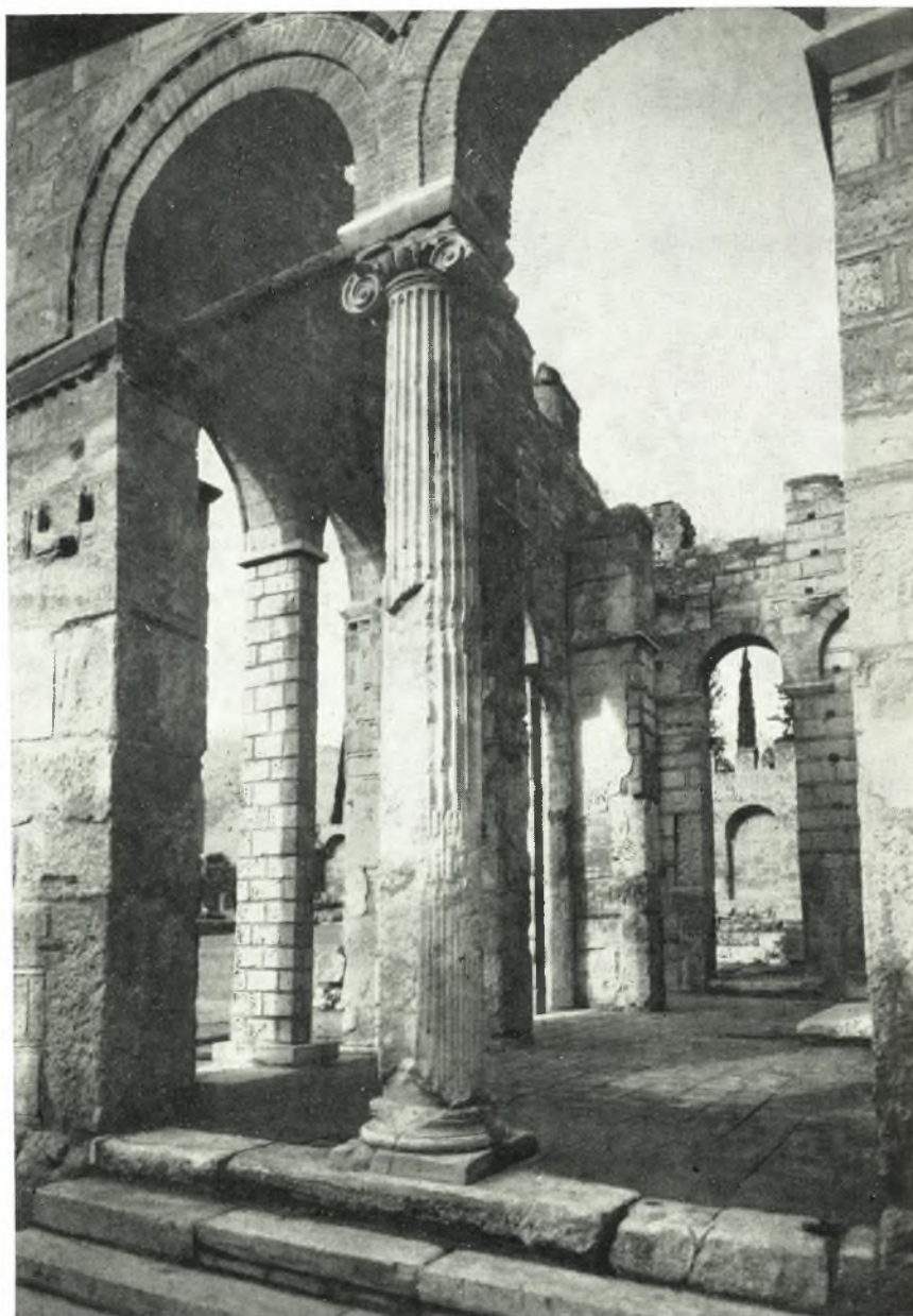
Όψις από Νότου τοῦ ἐσωτερικοῦ τοῦ ἐξωνάρθηκος τοῦ καθολικοῦ τῆς Μ. Δαφνίου μετὰ τὰς ἐργασίας ἀποκαταστάσεως αὐτοῦ.
