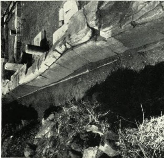
α. Οἱ ἀποκλίναντες τῆς καταζορύφου αὐτῶν θέσεως ὀρθοστάται τοῦ διμερείσματος Ν τῆς («Ἰγορῆς»).
