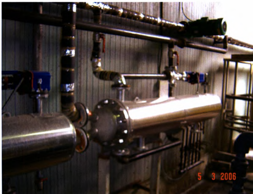
Φωτογραφία 5.6-Δύο εναλλάκτες νερού-νερού Τμήματος Κατακόρυφης Ηλεκτροστατικής Βαφής ονομαστικής ισχύος 400kW (344.234kcal/h) έκαστος
