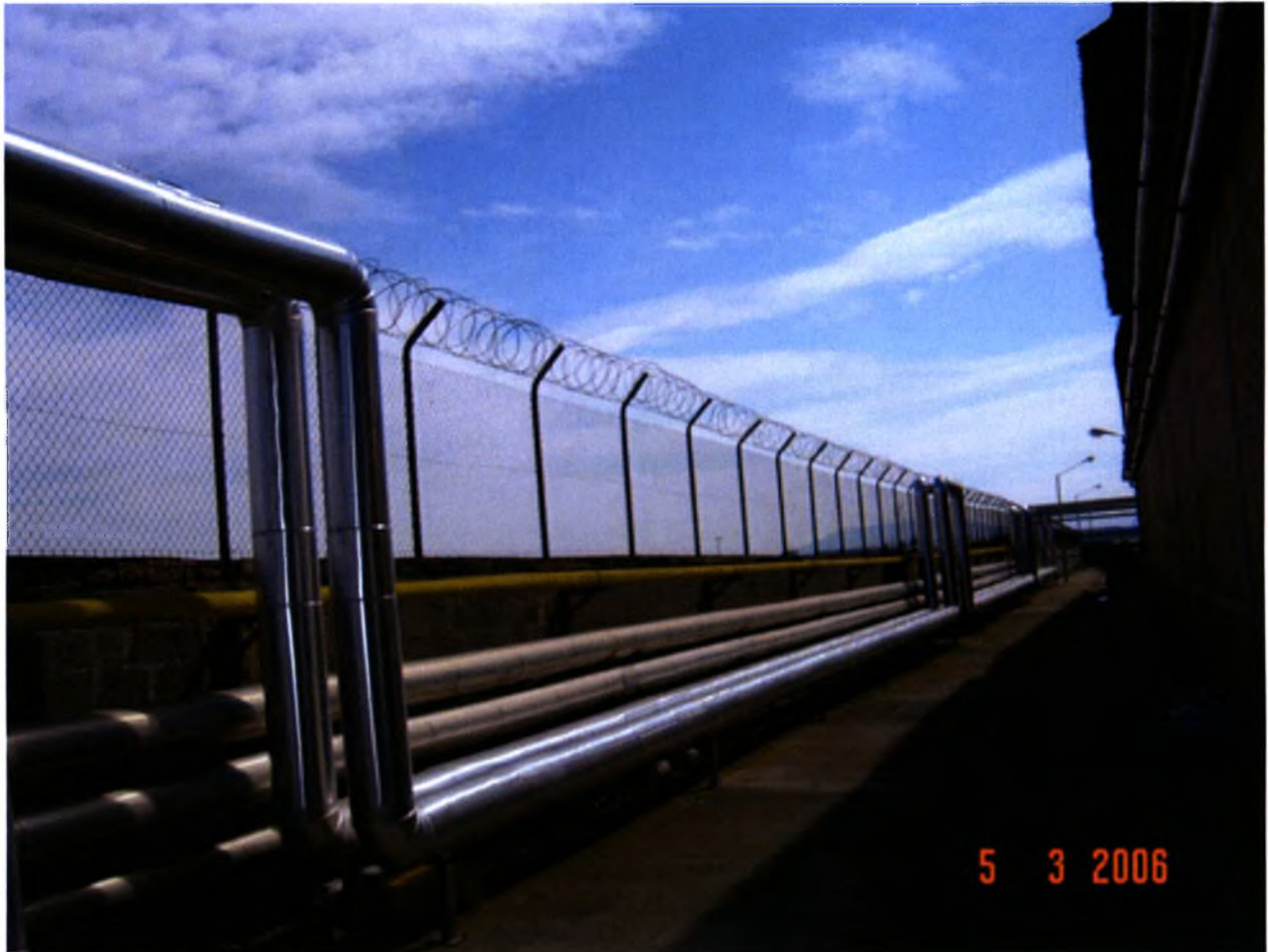
Φωτογραφία 5.1-Δίκτυο λαδιού Σ.Η.Θ.-ΒΙΟΚΑΡΠΕΤ όπου φαίνονται τα διαστολικά τύπου "U" λαδιού, όπου υπολογίστηκαν με την βοήθεια των βιβλίων "Walter Wagner-Heat Transfer Technique with Organic Media" & ΘΕΡΜΑΝΣΗ-ΚΛΙΜΑΤΙΣΜΟΣ RECKNAGEL-SPRENGER
