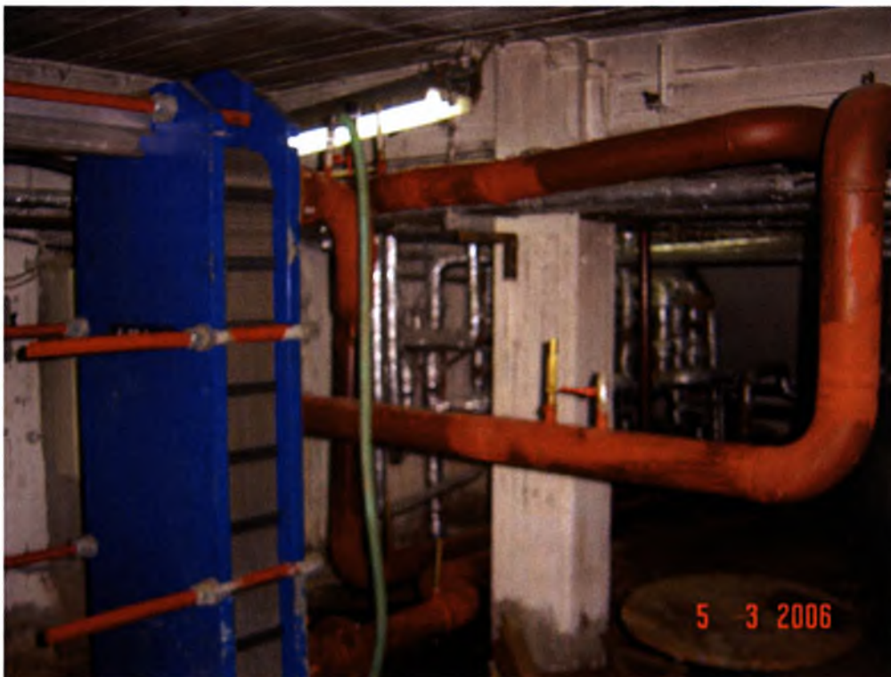
Φωτογραφία 5.4-Πλακοειδής εναλλάκτης νερού-νερού με σκοπό την θέρμανση των Γραφείων του Διοικητηρίου εκμεταλλευόμενος την ενέργεια του νερού του Σ.Η.Θ.. Το έργο αυτό ολοκληρώθηκε στις 20/10/2005 με ικανοποιητικά αποτελέσματα, ενώ αντικαταστάθηκαν λέβητες πετρελαίου ονομαστικής ισχύος 257.000 kcal/h, οι οποίοι εργάζονταν χωρίς αυτονομία.
