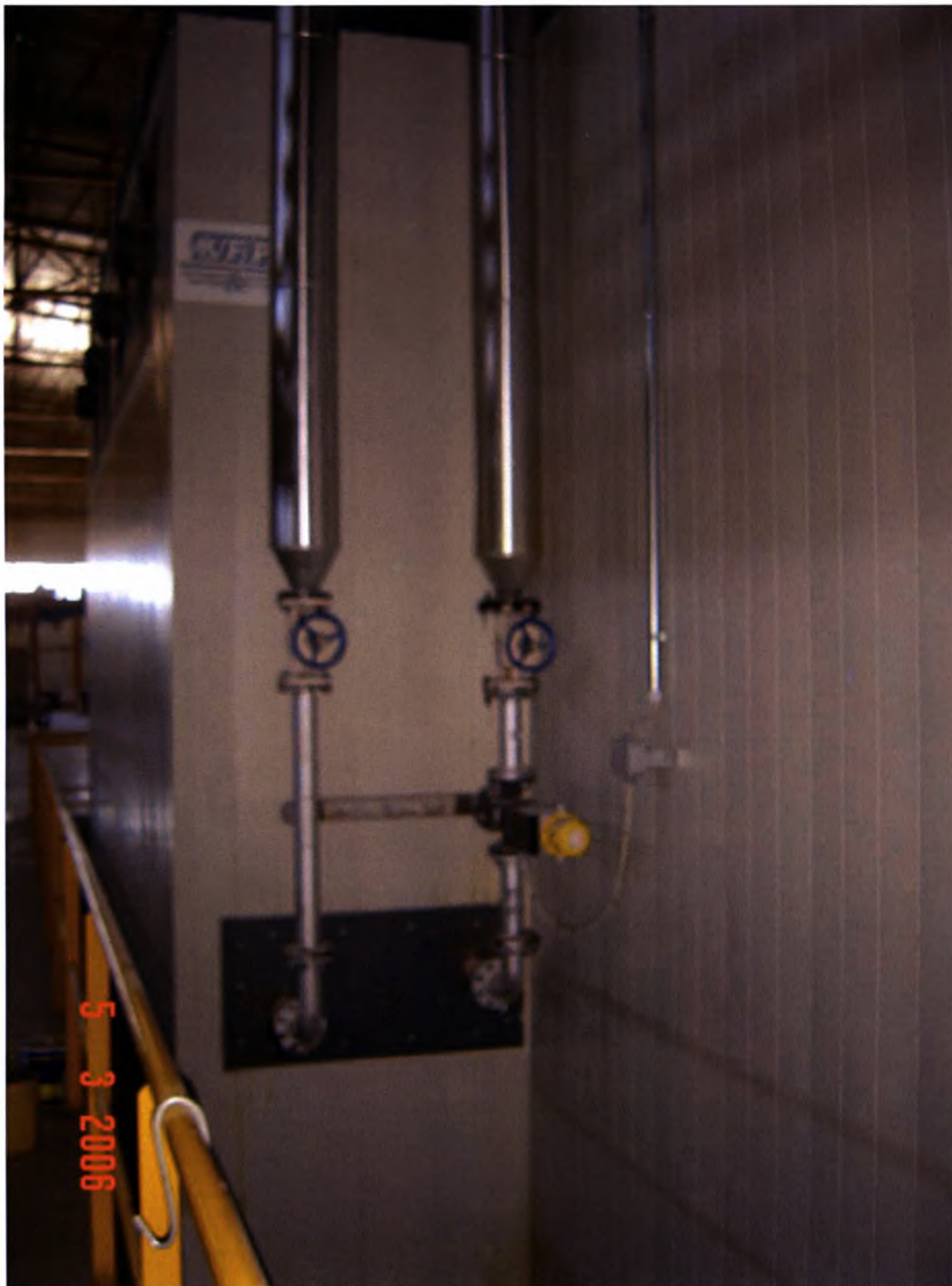
Φωτογραφία 5.2-Φούρνος λαδιού οριζόντιας ηλεκτροστατικής βαφής αλουμινίου ισχύος 450kW. Υπάρχει σε λειτουργία και φούρνος λαδιού κατακόρυφης ηλεκτροστατικής βαφής ισχύος 680kW.
