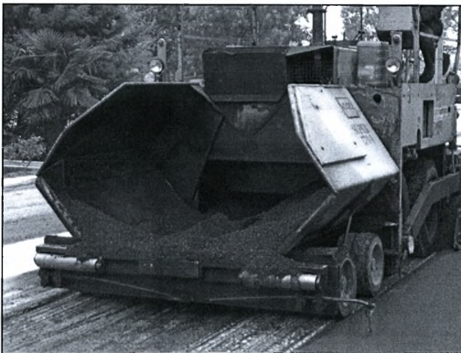
Εικόνα 16. Στιγμιότυπο εργασίας διάστρωσης ασφαλτοσκυροδέματος με ειδικό μηχάνημα (finisher) (Πηγή: προσωπικό αρχείο Δημήτρη Τσιώτα).
