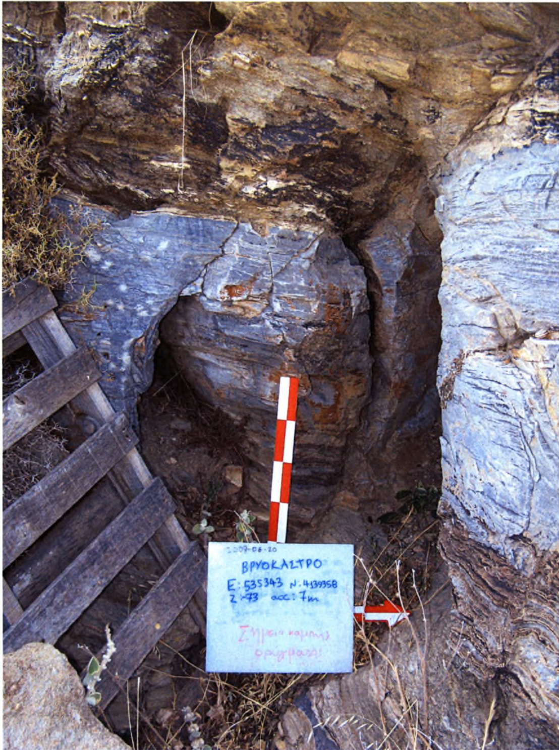
Εικ. 37: Πιθανό σημείο καμψής ορύγματος
