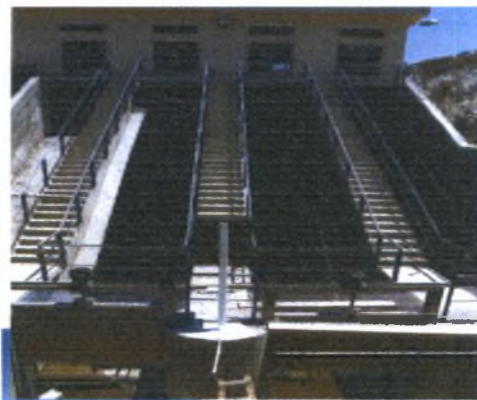
Εικόνα 2.5 κτίριο πάχυνσης λάσπης
