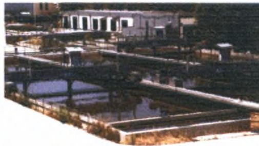
Εικόνα 2.4 δεξαμενές χημικής καθίζησης
