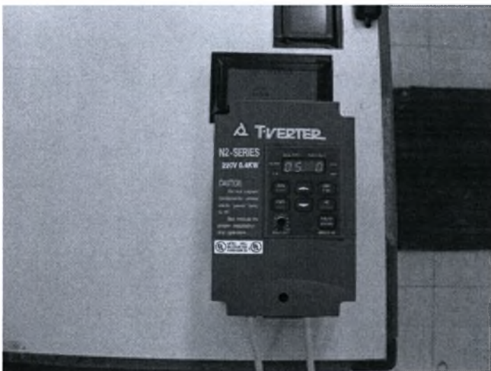
Εικόνα 3.13. Ο μετατροπέας της συχνότητας του ρεύματος (Inverter)
