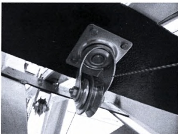
Εικόνα 3.11. Οι μεταλλικές κατασκευές και οι τροχαλίες
