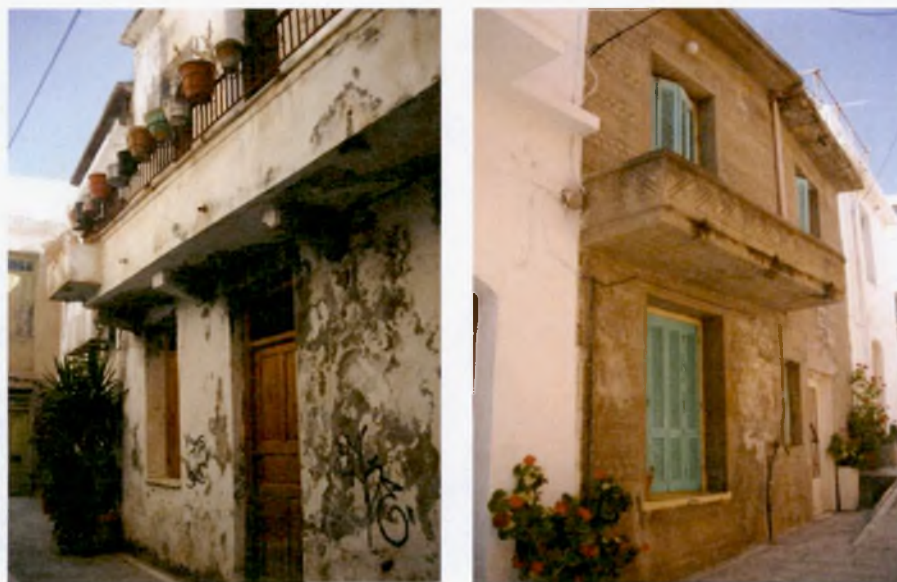
Φωτογραφία 5, 6. Αντιπροσωπευτικά παραδείγματα κτιρίων σε κακή κατάσταση (επί των οδών Μελετίου Μεταξάκη και Μακεδονίας)
