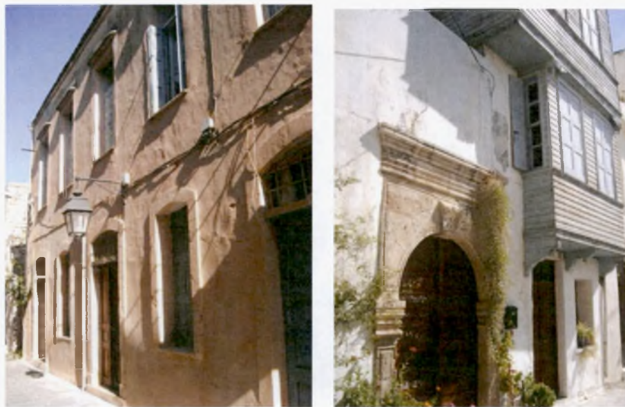
Φωτογραφία 3,4. Αντιπροσωπευτικά παραδείγματα κτιρίων σε μέτρια κατάσταση (επί των οδών Παπαμιχελάκη και Βερνάδου)
