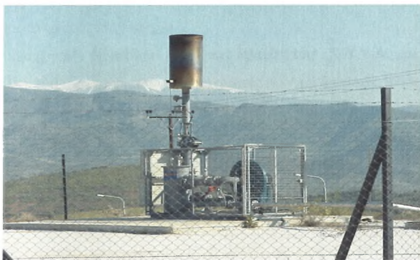
Εικόνα 5.3: Πυρσός καύσης του βιοαερίου που παράγεται στο Χ.Υ.Τ.Α. Λάρισας
