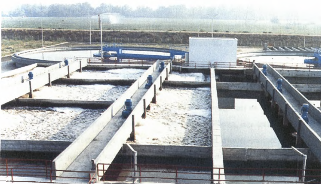
Εικόνα 4.2: Αερόβιος βιολογικός καθαρισμός
