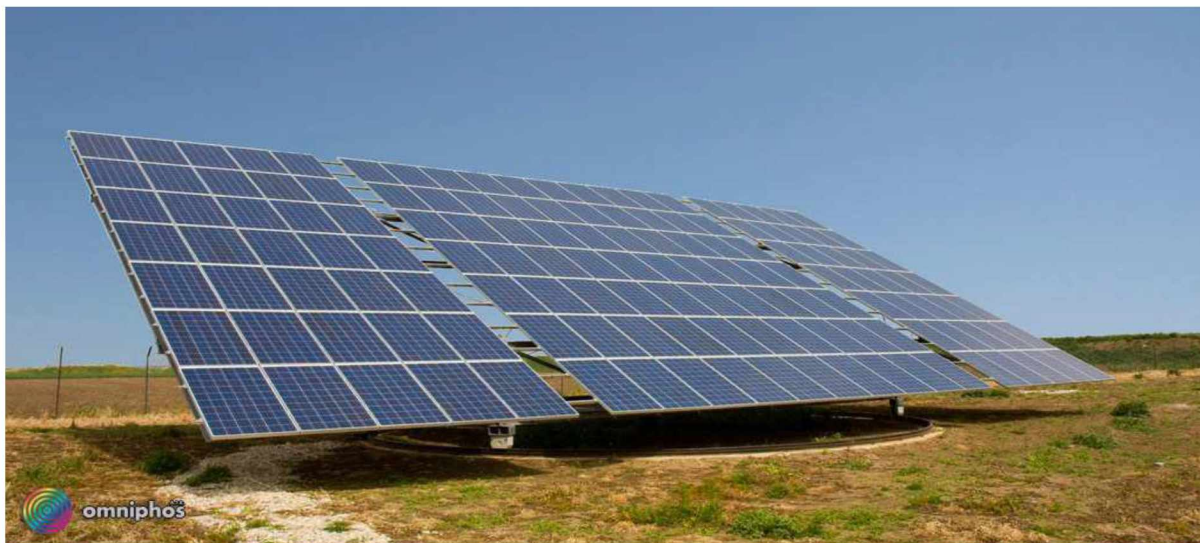
Εικόνα 1.2 Παραγωγή ηλεκτρικής ενέργειας από Φ/Β
