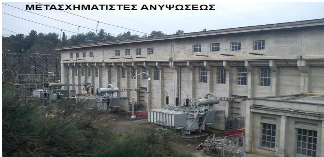
Εικόνα 293: Οι μετασχηματιστές ανυψώσεως του ΥΗΣ Πλαστήρα. Ανάκτηση από: https://geo.civ.uth.gr/images/documents/plastira01.pdf
