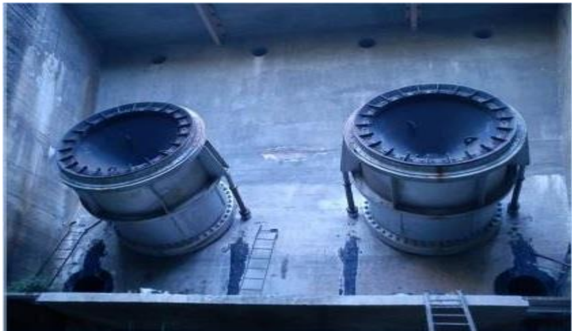
Εικόνα 37: Οι βαλβίδες εκτόνωσης (ζε-κρε) στο φράγμα του ΥΗΣ Πλαστήρα. Ανάκτηση από: https://geo.civ.uth.gr/images/documents/plastira02.pdf .
