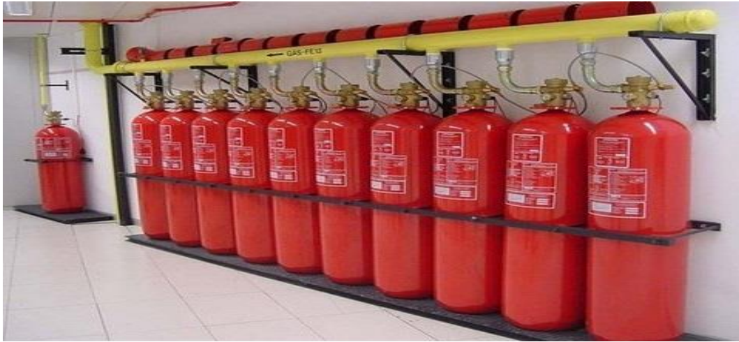
Εικόνα 298: Το σύστημα πυρόσβεσης ενός υδροηλεκτρικού σταθμού. Ανάκτηση από: https://www.indiamart.com/proddetail/fire-suppression-system-21570016191.html
