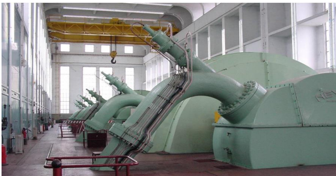
Εικόνα 41: Άποψη του εσωτερικού του σταθμού. Διακρίνονται οι μονάδες της ηλεκτροπαραγωγής. Ανάκτηση από: Λέρης Γ., Οι υδροηλεκτρικοί σταθμοί της ΔΕΗ, 2007.
