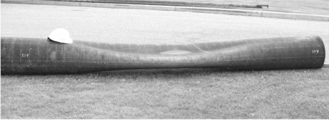
Σχήμα 1. 9 Φωτογραφία ενός αγωγού διαμέτρου 20 inches υλικού X80 ο οποίος έχει καταρρεύσει λόγω εξωτερικής πίεσης (Kyriakides_Corona 2007)
