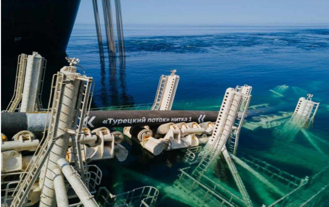
Σχήμα1. 1 Ο αγωγός μεταφοράς φυσικού αερίου Turk Stream
