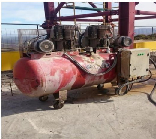
Εικόνα 9.6 Κομπρεσέρ στο εργοτάξιο της ΣΓ26 (Πηγή: Ίδια επεξεργασία)
