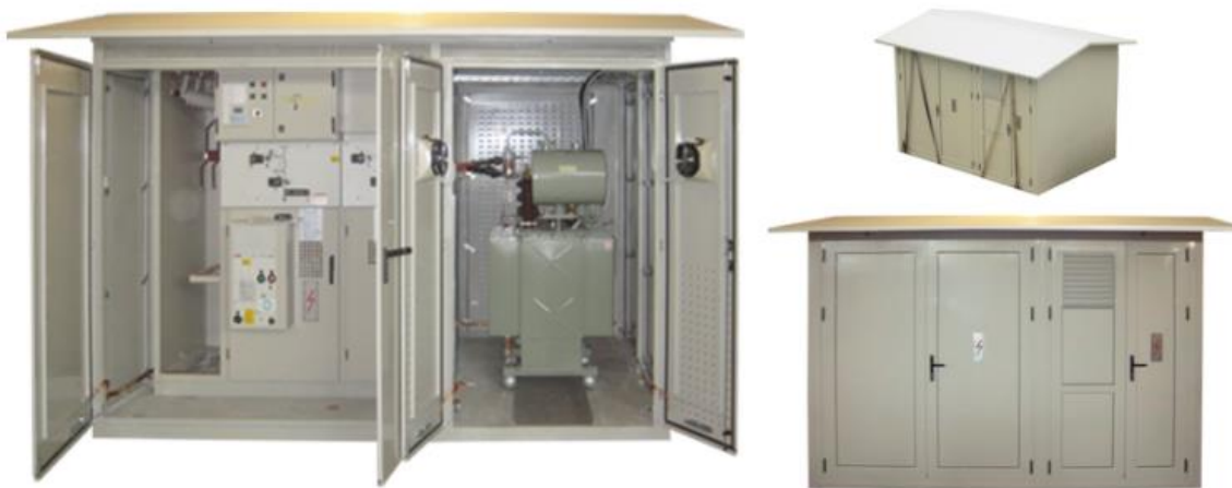
Εικόνα 4.16α: Υποσταθμός (κιόσκι) Μ.Τ.-Χ.Τ. [33]
