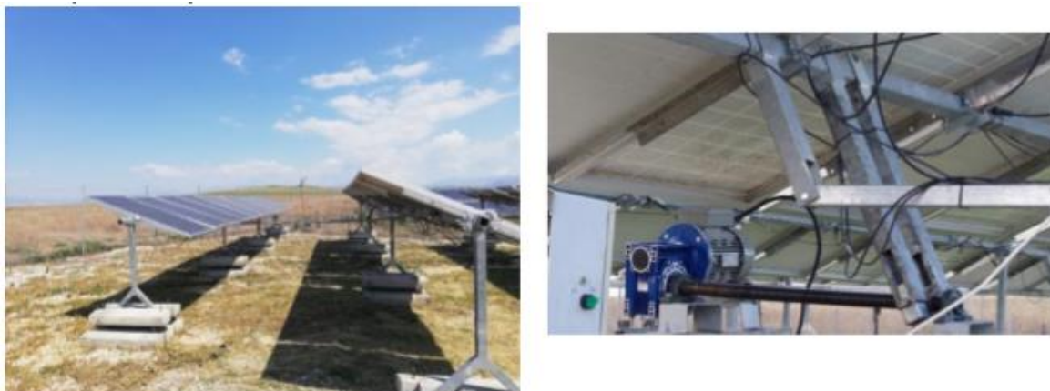
Εικόνα 4.6: Φ/Β πλαίσια και σύστημα «tracker 1X ArmaSide» [25]
