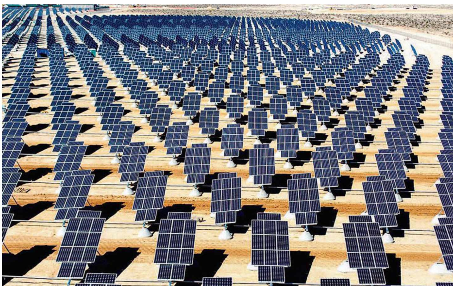
Εικόνα 16: Φωτοβολταϊκό πάρκο Πηγή: (Λιάγγου,2016)
