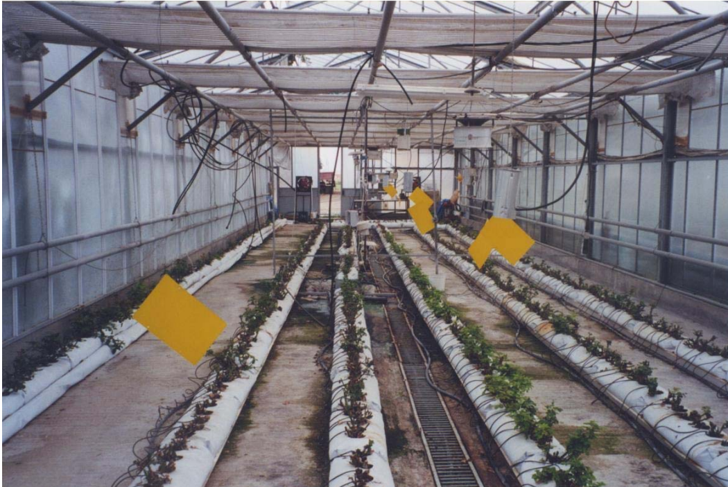
Εικόνα 3.4. Άποψη του εσωτερικού του θερμοκηπίου με το σύστημα δροσισμού εκτός λειτουργίας.
