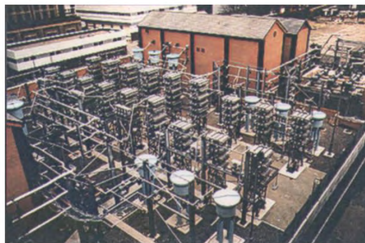
Εικόνα 3β: Σταθμός SVC.
