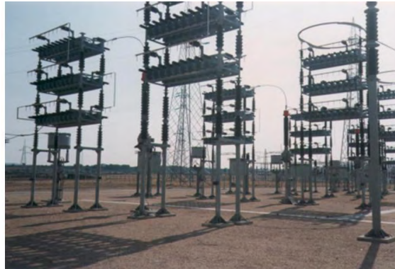
Εικόνα 3α: Τράπεζες πυκνωτών υψηλής τάσης
