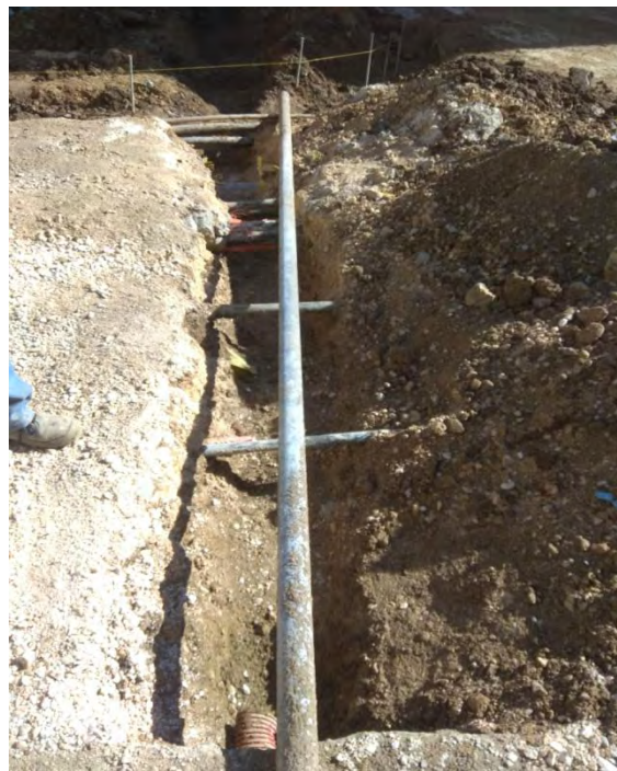
Εικόνα 4.10 προβλήματα στην κατασκευή (πηγή: προσωπικό αρχείο)
