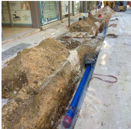
Εικόνα 4.12 προβλήματα στην κατασκευή (πηγή: προσωπικό αρχείο)
