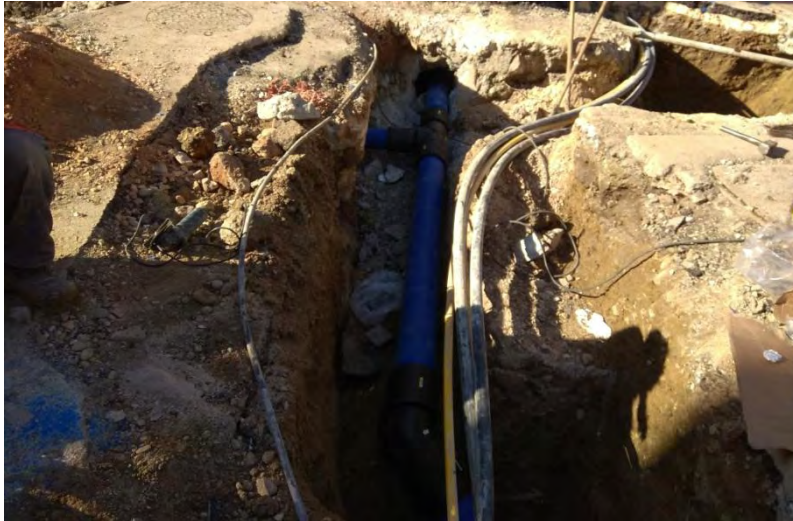
Εικόνα 4.11 προβλήματα στην κατασκευή (πηγή: προσωπικό αρχείο)
