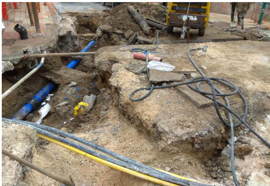
Εικόνα 4.14 προβλήματα στην κατασκευή (πηγή: προσωπικό αρχείο)
