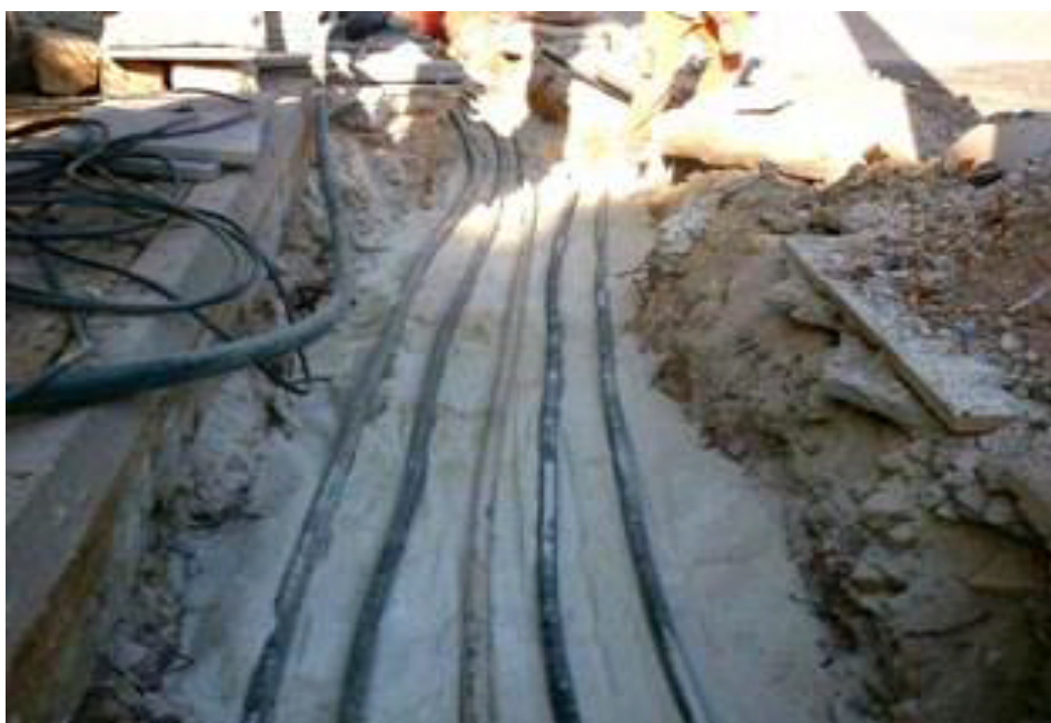
Εικόνα 4.8 προβλήματα στην κατασκευή (πηγή: προσωπικό αρχείο)
