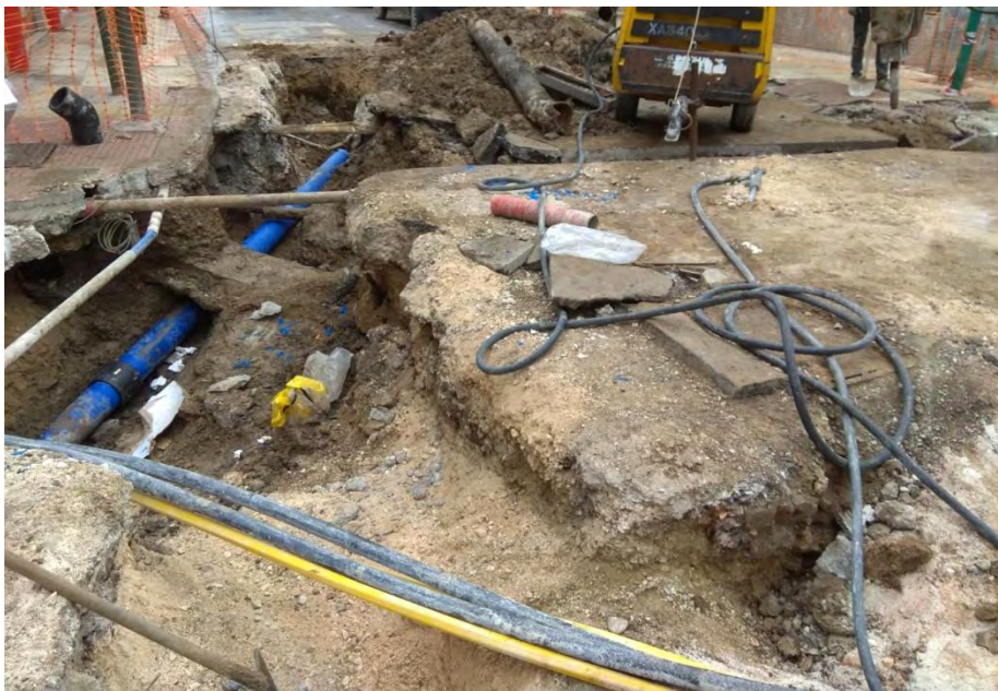
Εικόνα 4.13 προβλήματα στην κατασκευή (πηγή: προσωπικό αρχείο)
