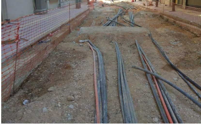
Εικόνα 4.9 προβλήματα στην κατασκευή (πηγή: προσωπικό αρχείο)
