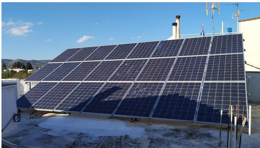
Εικόνα 13: Πλαίσια σε ταράτσα κτιρίου
