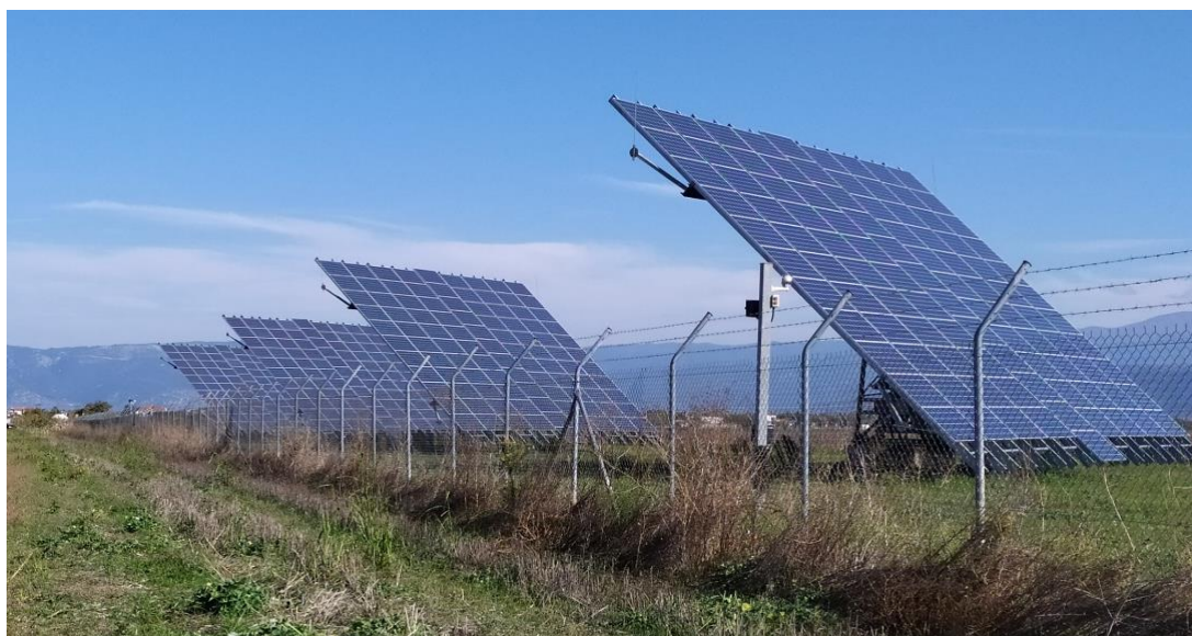
Εικόνα 12: Συστήματα tracker σε φωτοβολταϊκό πάρκο
