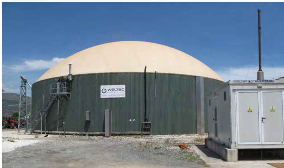
Εικόνα 4.4. : Αναερόβιος βιοαντιδραστήρας της μονάδος παραγωγής βιοαερίου (Αφοι ΣΕΪΤΗ Α.Ε.)
