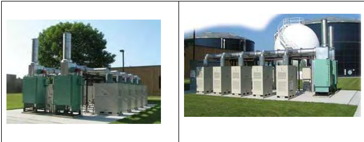
Εικόνα 6.6 : Συστοιχία μικροστρόβιλων βιοαερίου
