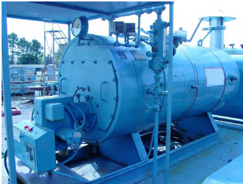
Εικόνα 13 Λέβητας ατμού με πετρέλαιο
