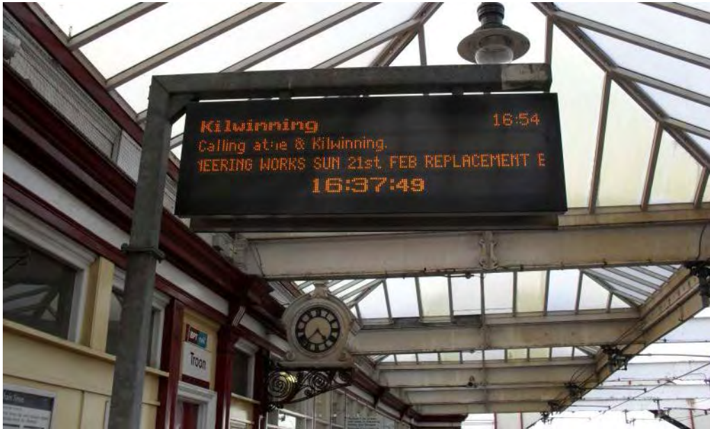
Εικόνα 4.1 Σύστημα PIS στο σιδηρόδρομο της Σκωτίας - ενημέρωση του κοινού για την ύπαρξη συμβάντος (Scotland's online railway community, 2019)
