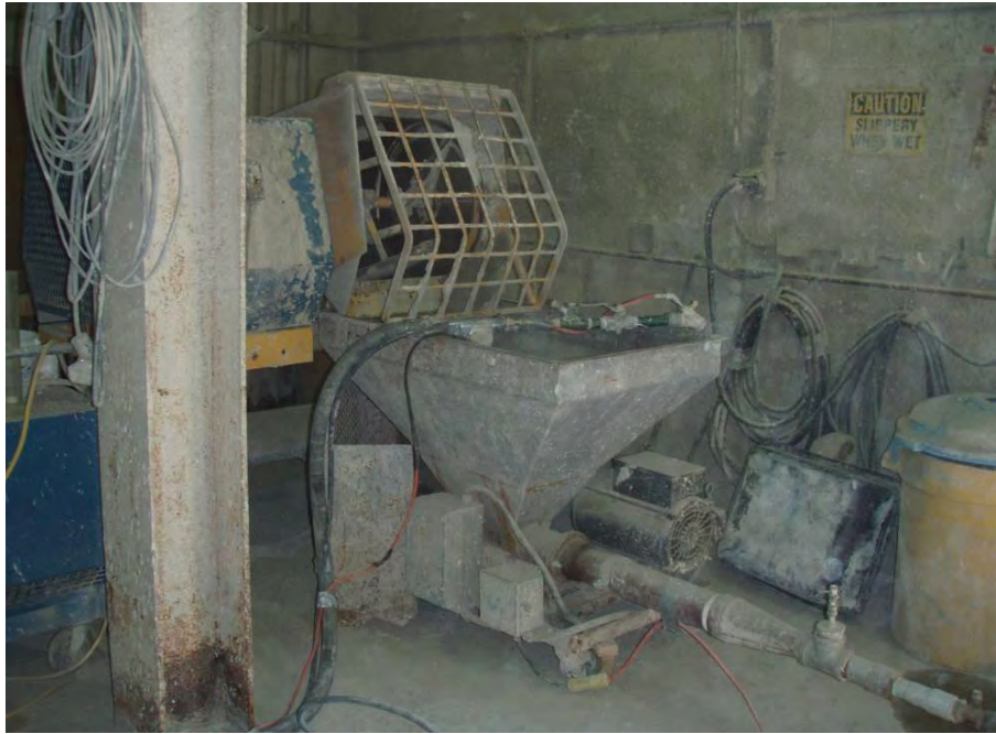
Εικόνα 20: Ξηρό μείγμα εκτοξευόμενου πυράντοχου υλικού έτοιμο: Μηχανή παραγωγής και Σωλήνας εφαρμογής (πηγή:
