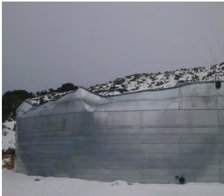
Εικόνα 1.4: Δεξαμενή με λυγισμό μορφής διαμαντιού στο πάνω αριστερό της τμήμα.
