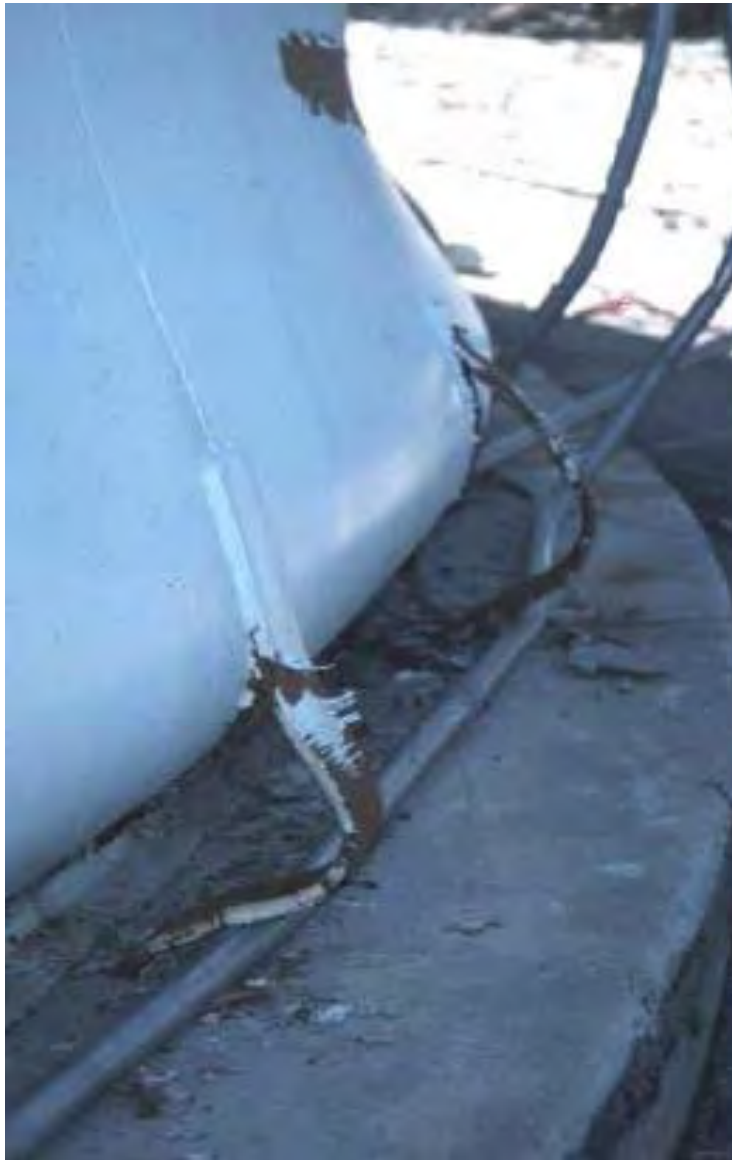
Εικόνα 1.5: Λυγισμός σε σχήμα πέλματος ελέφαντα σε δεξαμενή αποθήκευσης υγρών καυσίμων.
