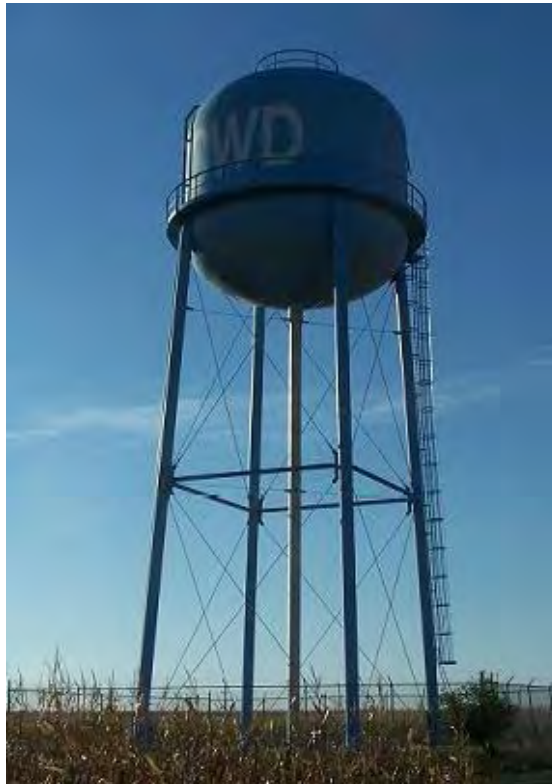
Εικόνα 1.2: Υπερψωμένη μεταλλική δεξαμενή αποθήκευσης υγρών
