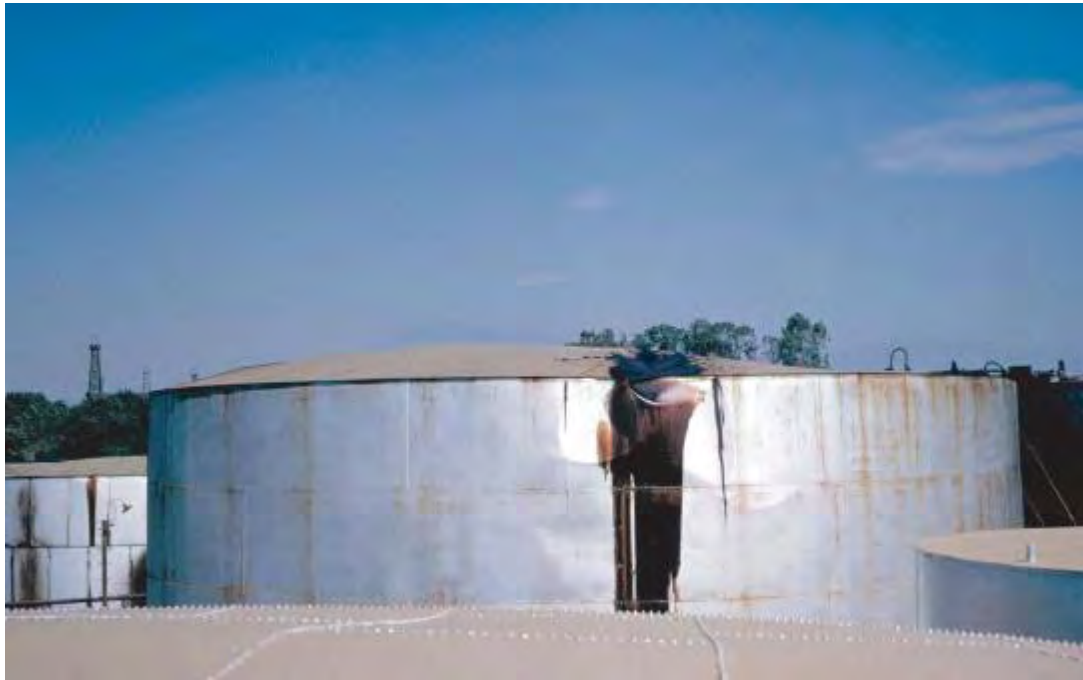
Εικόνα 1.6: Βλάβη σε δεξαμενή στην Καλιφόρνια λόγω κυματισμού του περιεχόμενου υγρού
