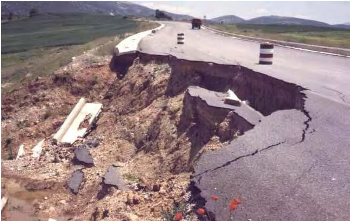
Σχήμα 3.4: Ολίσθηση οδοστρώματος επαρχιακής οδού (Σεισμός Κοζάνης, 1995).
