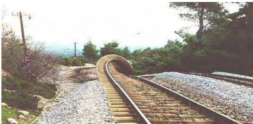
Σχήμα 3.15: Η παραμόρφωση της σιδηροδρομικής γραμμής από την κατολίπιση της Μαλακάσας.
