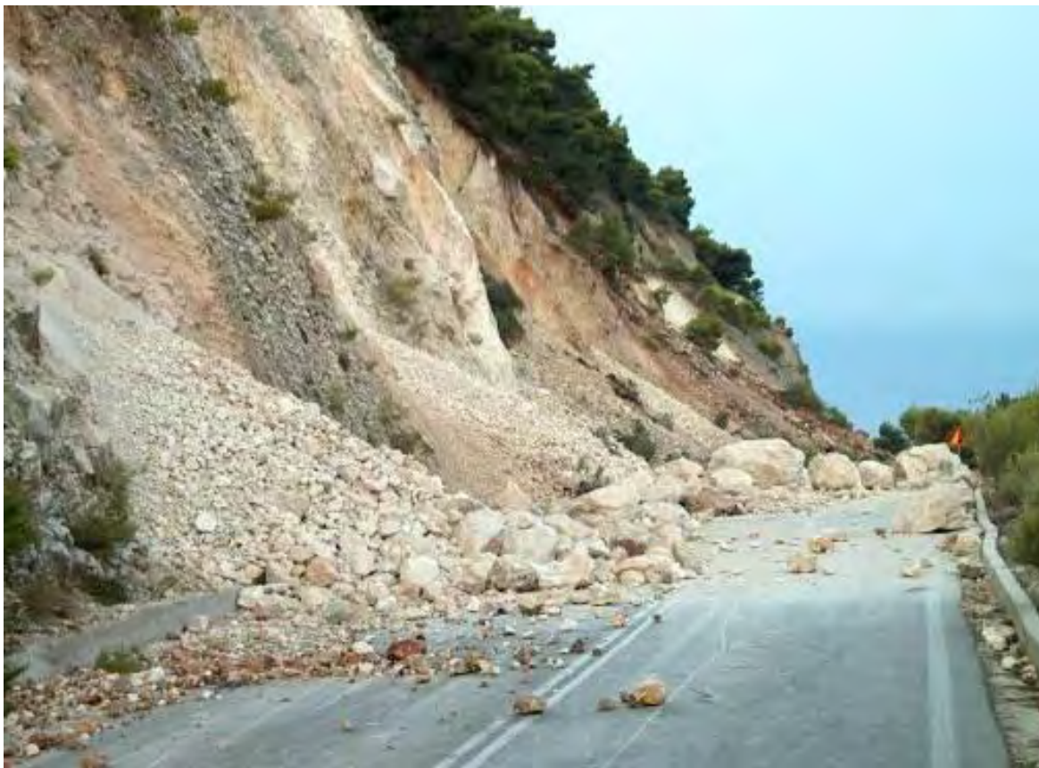
Σχήμα 3.3: Αστοχία Πρανούς και παρακώλυση κυκλοφορίας (Σεισμός Λευκάδας, 2003).
