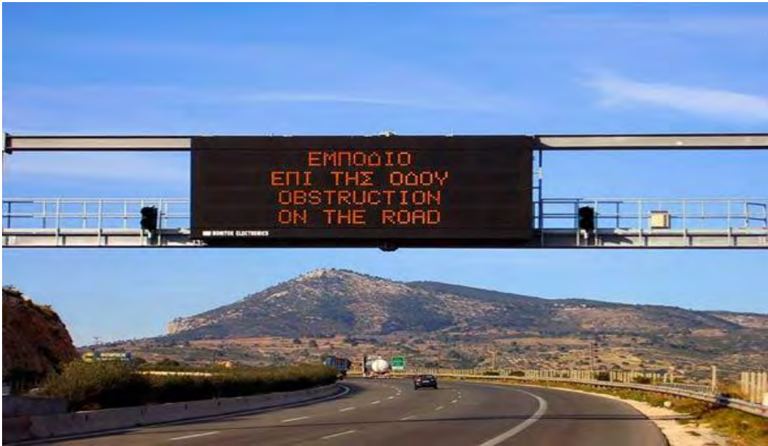
Εικόνα 43 : Ηλεκτρονικές πινακίδες μεταβλητών μηνυμάτων
