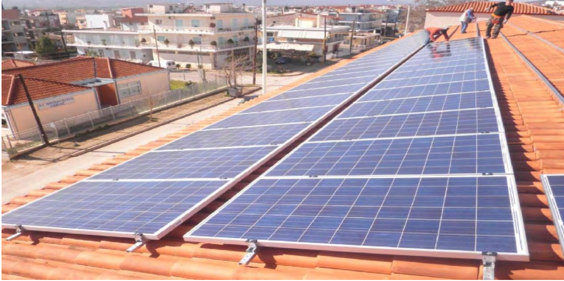
Εικόνα 36: Φωτοβολταϊκά σε στέγη κτιρίου
