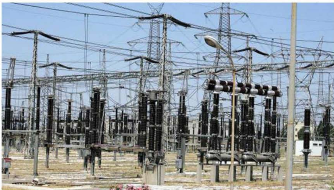
Εικόνα 1.12: Υποσταθμός υποβιβασμού τάσης
