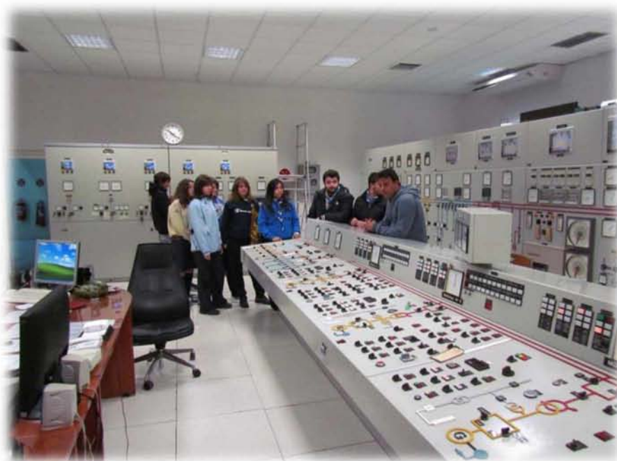
Εικόνα 4.12: Κέντρο ελέγχου Υδροηλεκτρικού σταθμού Σφηκιάς
