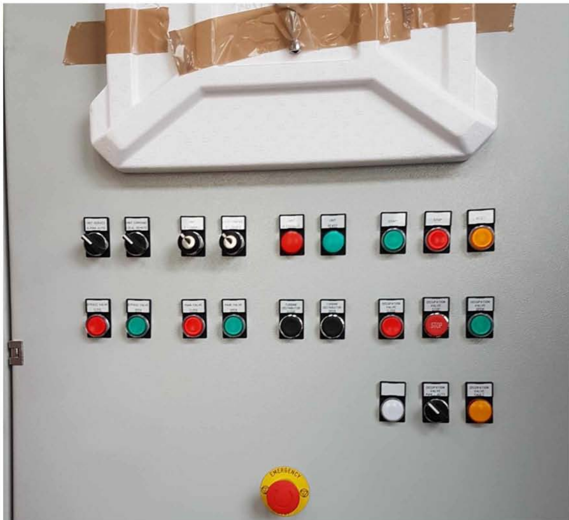
Εικόνα 5.6 : Πίνακας ελέγχου και χειρισμών
