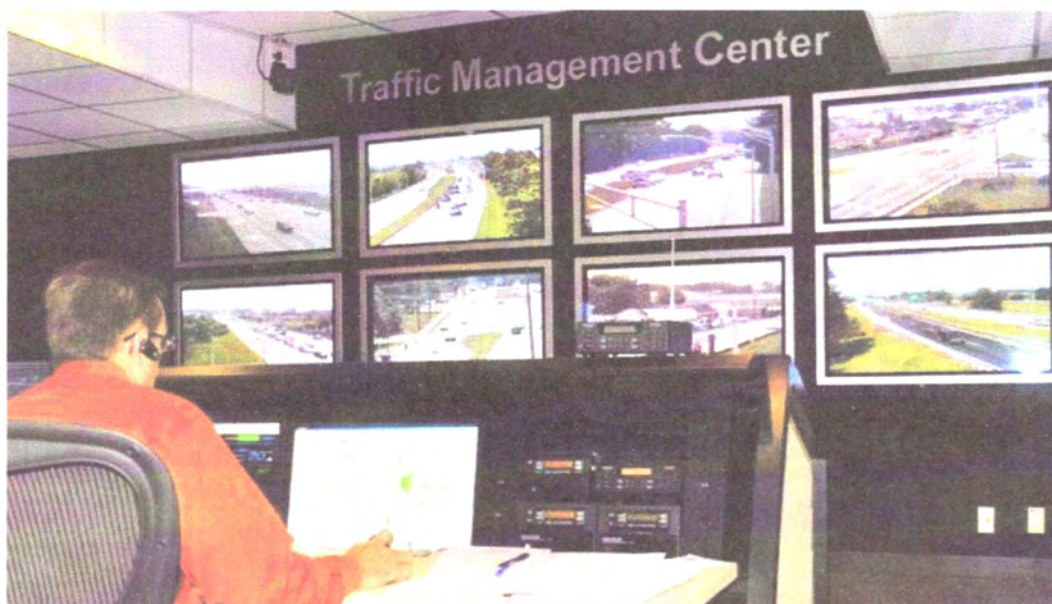
Σχήμα 3.9. Κέντρο διαχείρισης κυκλοφορίας
