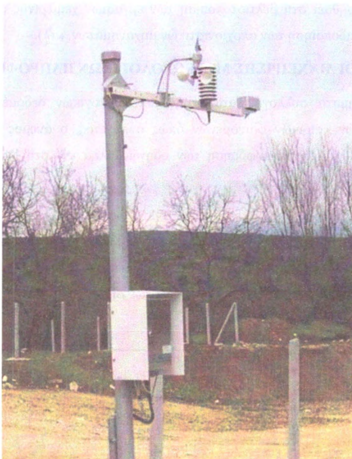
Σχήμα 4.3. Σταθμός Διαχείρισης Μετεωρολογικών Πληροφοριών Οδού (Road Weather Information System, RWIS) 12
