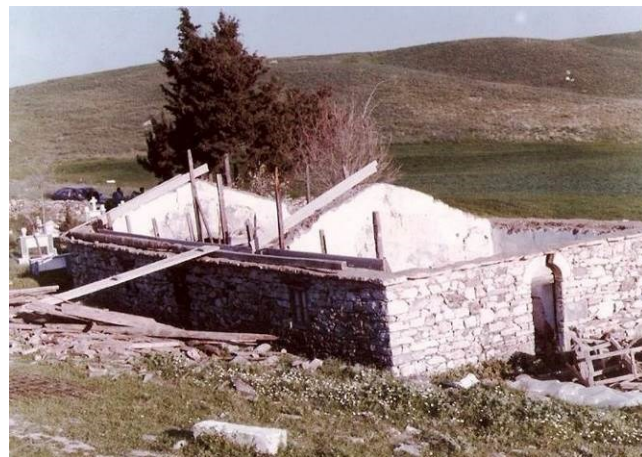
Εικόνα 11: Ο ναός μετά την αποξήλωση της ετοιμόρροπης στέγης.
