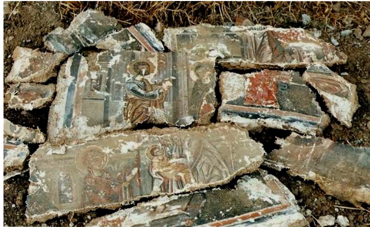
Εικόνα 18 : Αποκολλημένα τμήματα σοβά με αιογραφίες, κυρίως λόγω υγρασίας.
