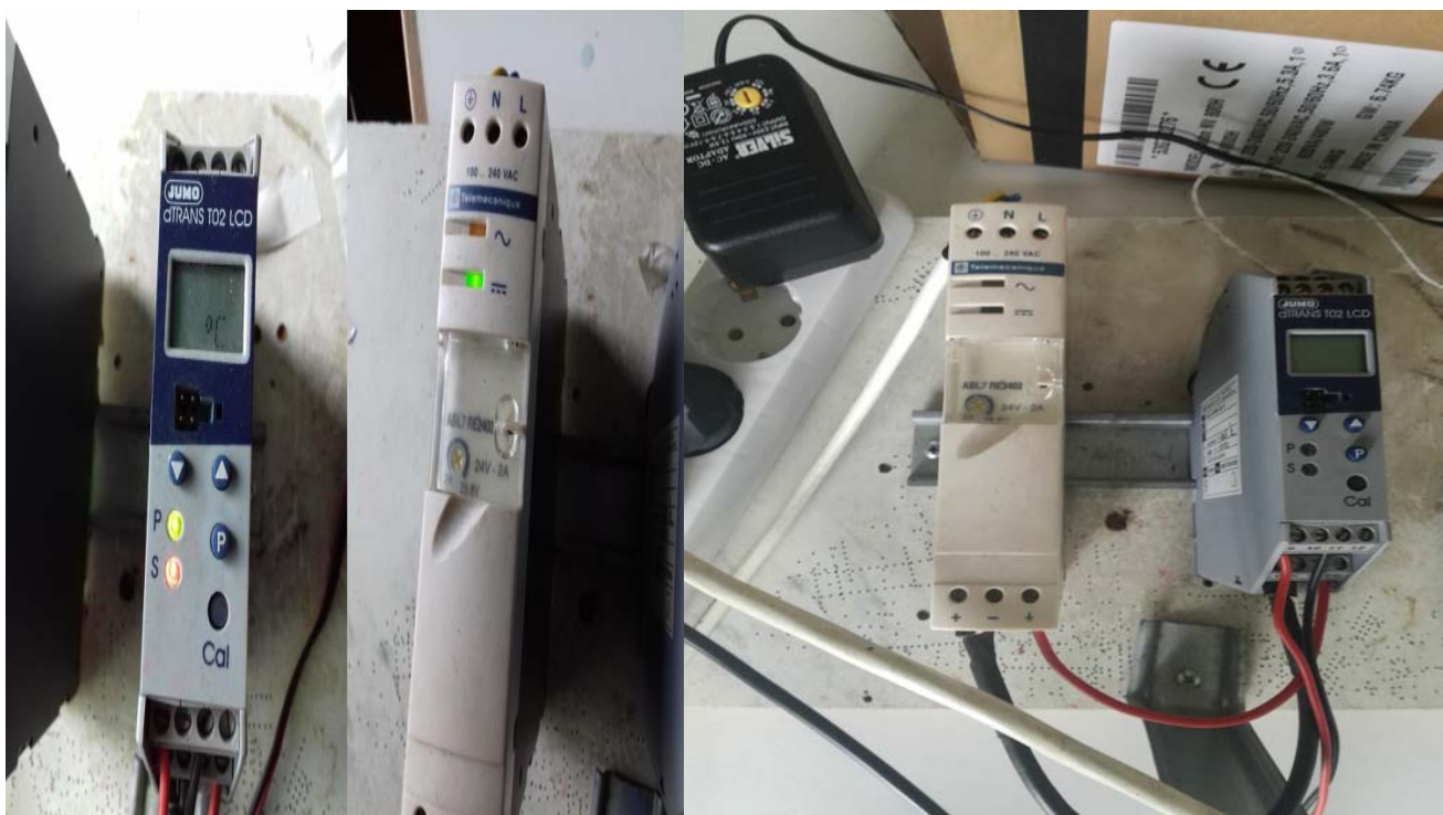
Εικόνα 3.13 Το transmitter Jumo και το τροφοδοτικό της Telemecanique
