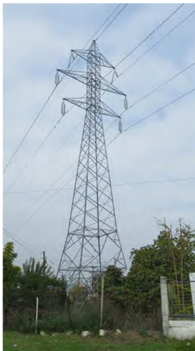
Εικόνα 1.3.8.1: Μεταλλικός πυλώνας υψηλής τάσης ΔΕΗ
