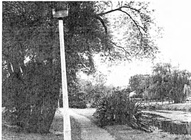
Φωτογραφία 17.2 - Στύλος φωτισμού μεσαίου ύψους
