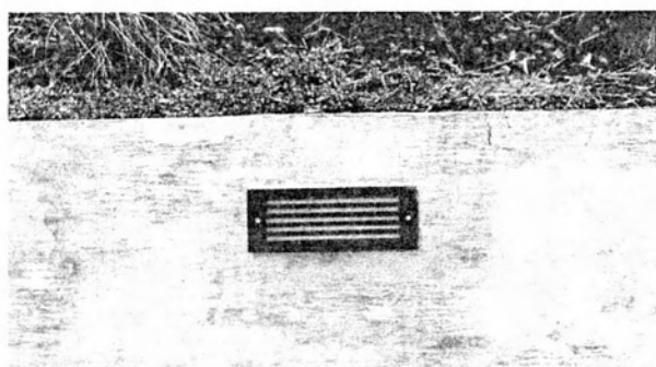
Φωτογραφία 17.1 - Χαμηλά τοποθετημένος φωτισμός σε τοίχο
