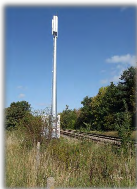
Σχήμα 5.13: Επίγεια κεραιά GSMR τοποθετημένη ανά 8 χιλιόμετρα σιδηροδρομικής γραμμής
