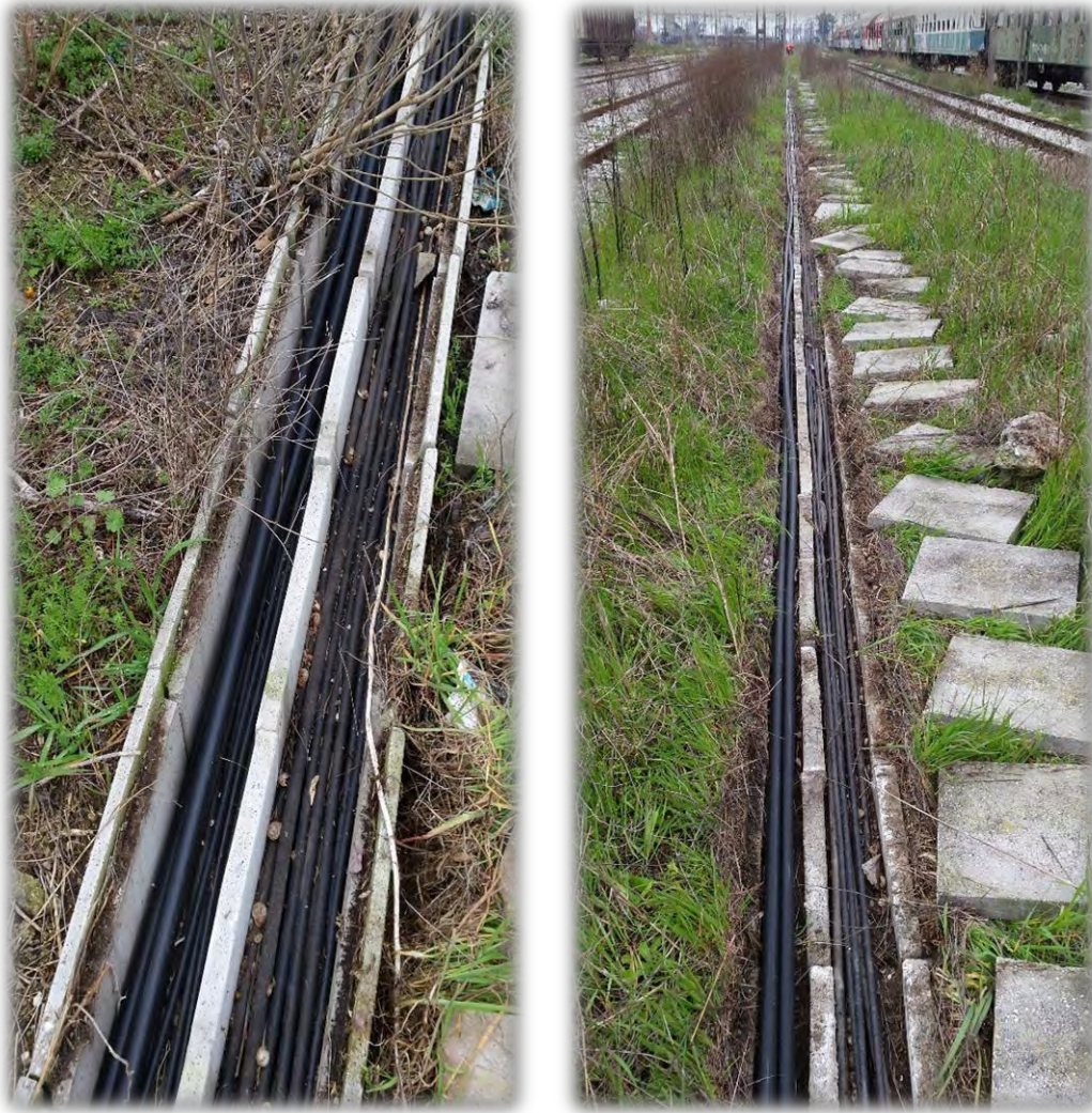
Σχήμα 2.11: Δίδυμοι Καλωδιοφορείς εκ σκυροδέματος
