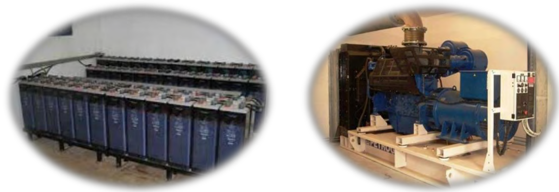
Σχήμα 2.12: α) Συστοιχία συσσωρευτών και β) ηλεκτροπαραγωγό ζεύγος (Η/Ζ)
